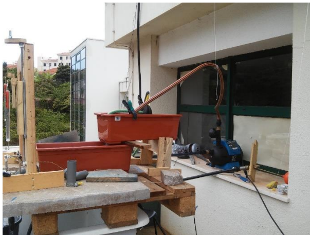
Figura P.1 – Bomba de reciclagem de água, tanque de estabilização e tanque de captura.
