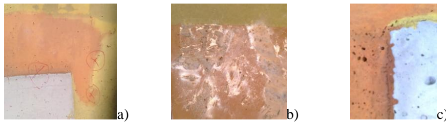
Figura 32. Problemas na execução da betonagem: a) Dano superficial, b) Falta de aderência na 'interface', c) Escoamento indevido do betão.
