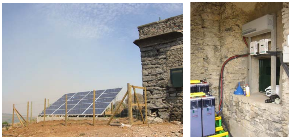
Figura 2.26 Bica da Cana, gerador FV, banco de baterias, reguladores e inversor
