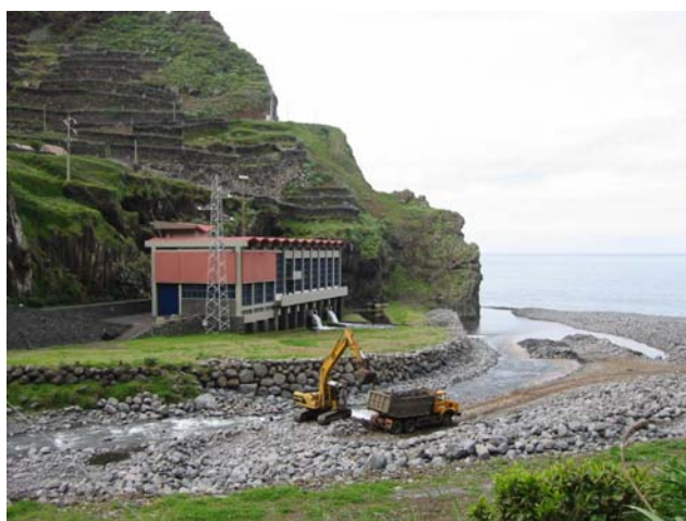
Figura 1.17 Central hídrica da Ribeira da Janela, EEM
