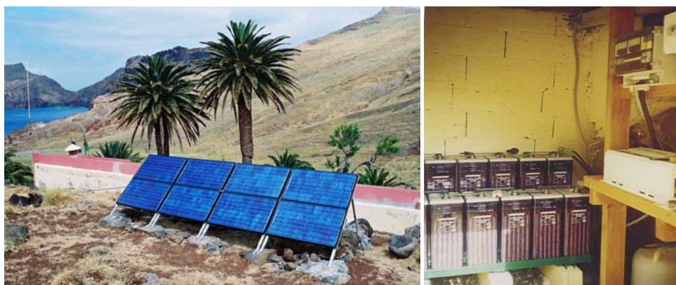
Figura 2.23 Casa do Sardinha, gerador fotovoltaico e banco de baterias
