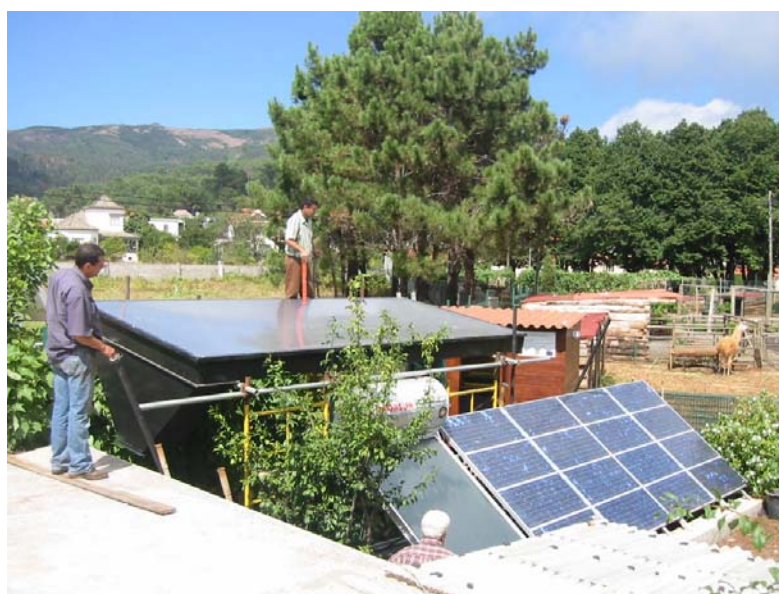
Figura 2.27 Sistemas solares fotovoltaico e térmicos (ar e água)
