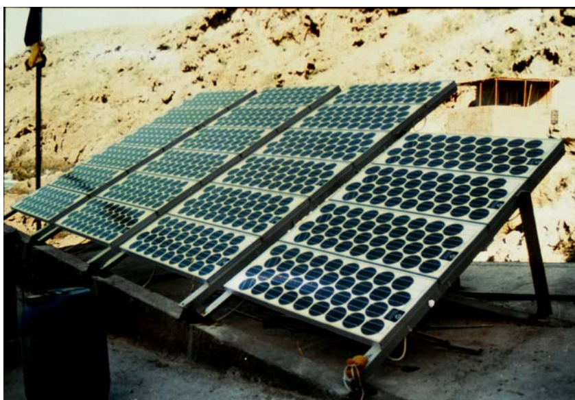
Figura 1.15 Selvagem Grande, primeira instalação fotovoltaica de Portugal -1983
