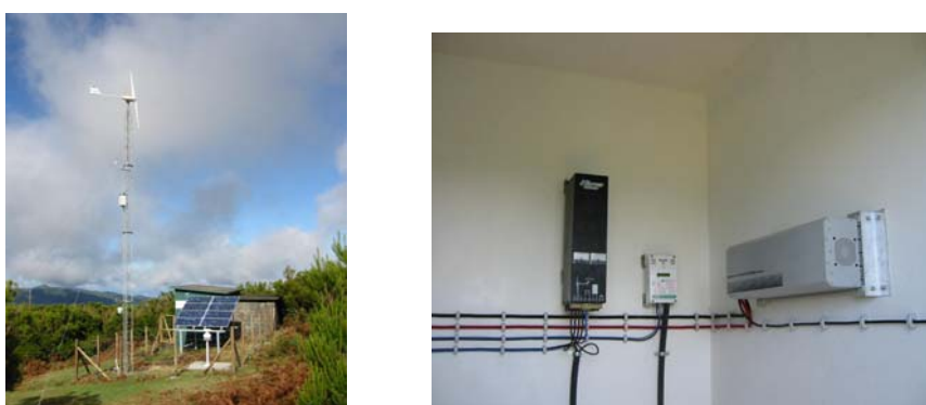
Figura 2.35 Fanal, sistema híbrido, inversor e reguladores
