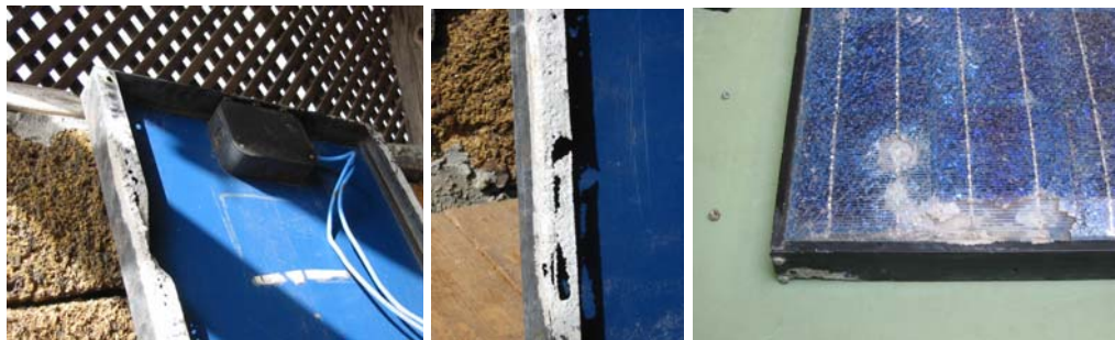
Figura 2.37 Degradação de módulo fotovoltaico- Deserta Grande
