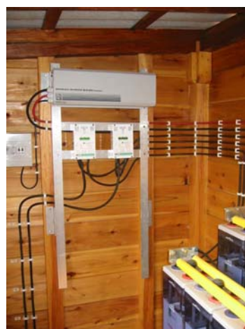
Figura 2.29 Banco de Baterias
