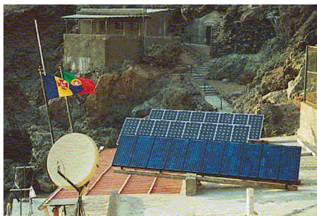
Figura 2.24 Instalações fotovoltaicas da Selvagem Grande, 2005
