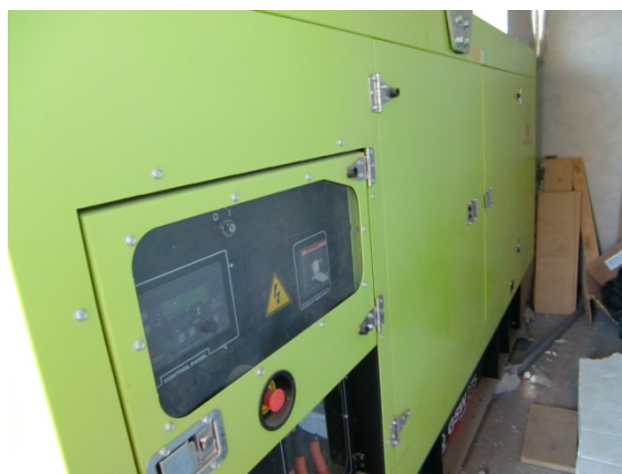
Figura 4.20 – Gerador de alimentação energia do edifício.
