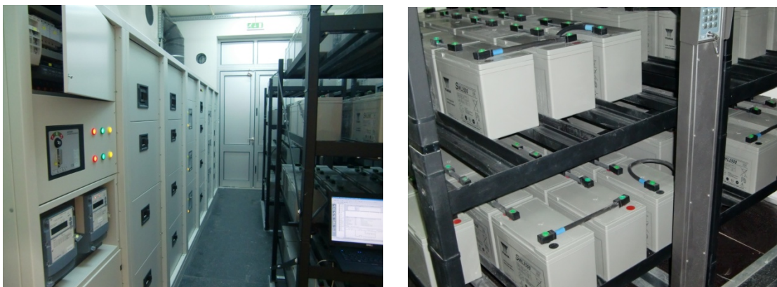
Figura 4.16 – Sala técnica com as baterias UPS
