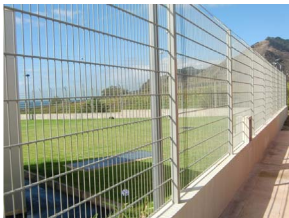
Figura 4.15 – Vedação exterior Betafence do edificio, vindo de Espanha
