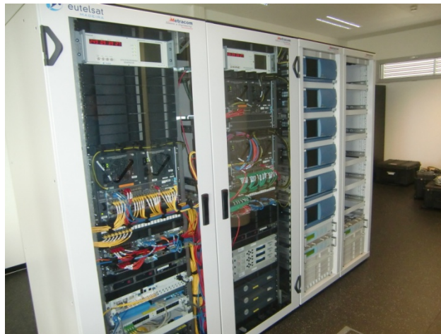
Figura 4.21 – Sala do equipamento de processamento de dados
