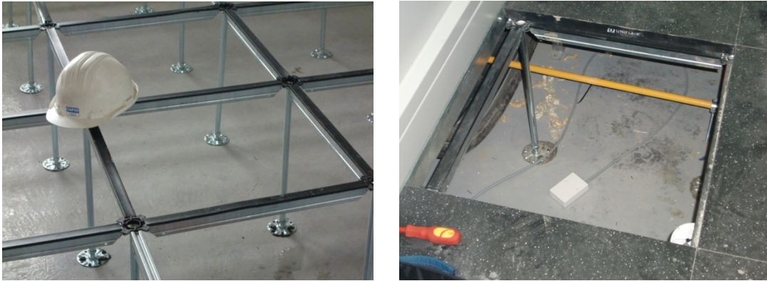
Figura 4.13 – Pavimento elevado Uniflair das salas técnicas vindo de Itália.
