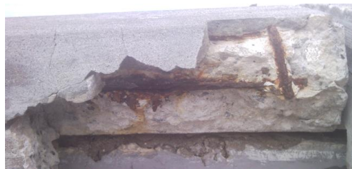
Figura 21 – Efeitos do processo de corrosão (fendilhação e destacamentos)
