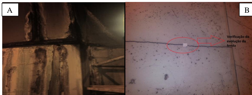
Figura 38 – A) - Infiltração de água nas juntas construtivas e fendas com eflorescências (local ≈ km 1+ 800), B) – Um dos locais onde esta a ser controlado a evolução da fendilhação (local ≈ km 1+ 300)
