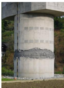
Figura 3 – Degradação de um dos pilares da Ponte de Chamadouro no IP3 (17)
