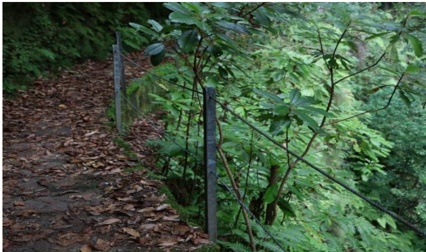
Figura 10 - Exemplo de um varandim em bom estado de conservação no PR 18 - Levada do Rei
