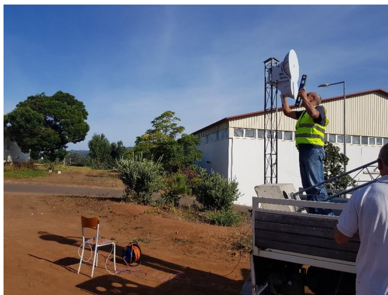
Figura 40- Montagem da antena slave .
