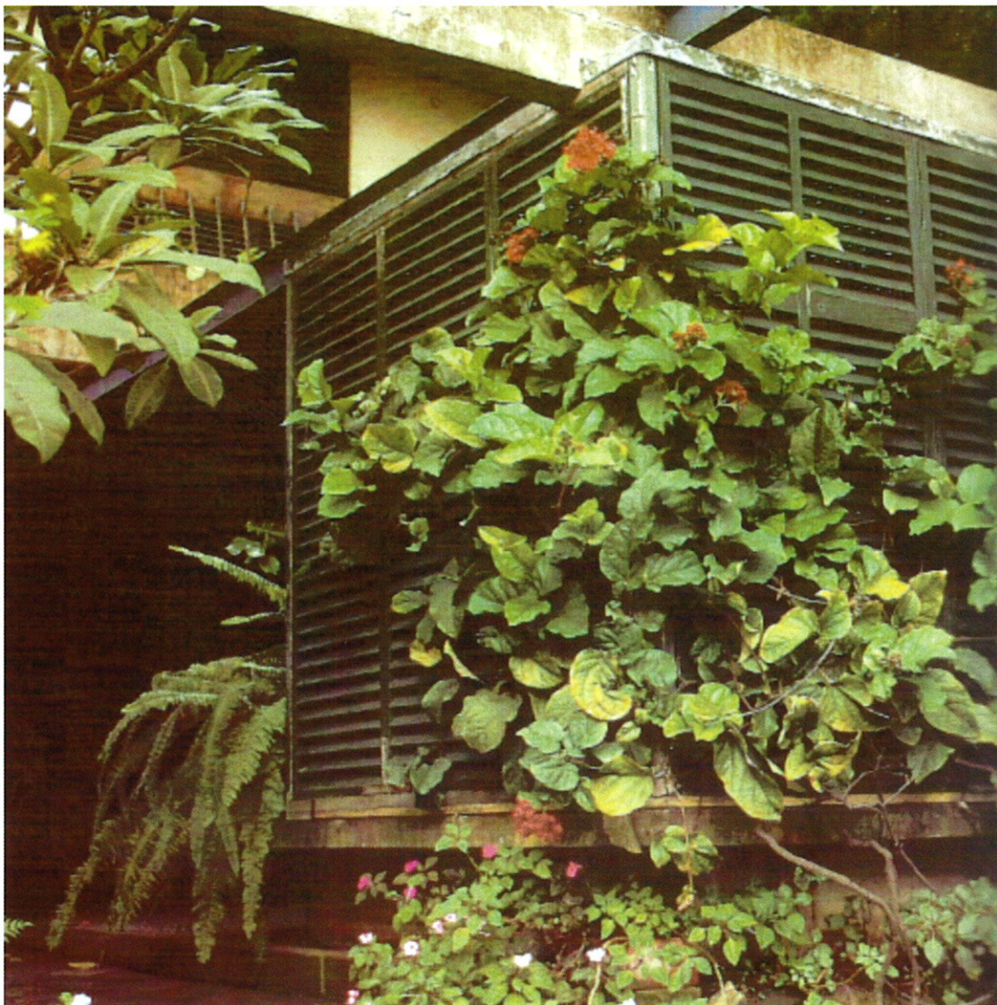
Figura 12 - Reinterpretação contemporânea de uma casinha de prazer, na Casa Bianchi de 1959, projecto do arquitecto Chorão Ramalho. Concebida em betão aparente e protegida por sucessivos tapas-sóis em fasquiados de madeira de tradição local. Fotografia por Emanuel Gaspar.
