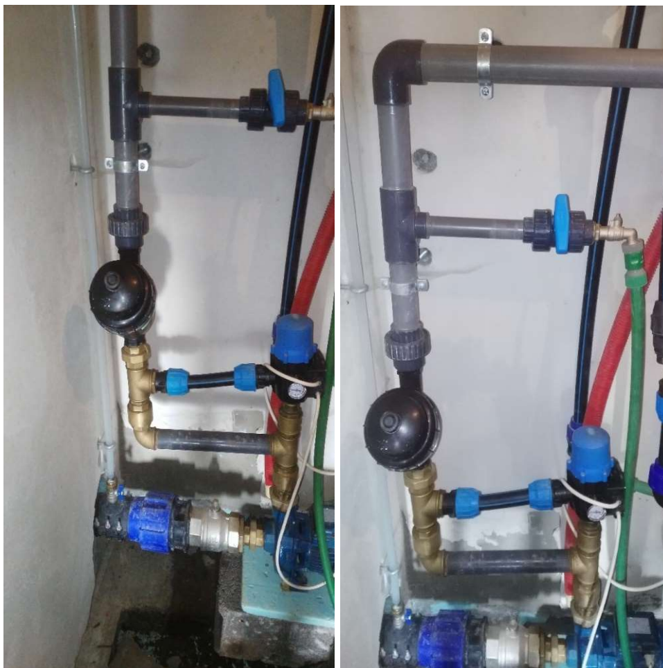
Figura 67 - Conjunto de válvulas, medidores e controladores (Fonte: Autor, 2019).
