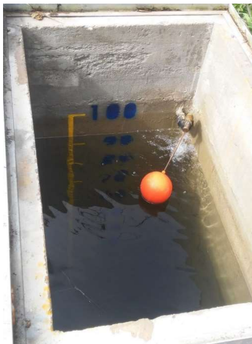
Figura 63 - Reservatório utilizado (Fonte: Autor, 2019).
