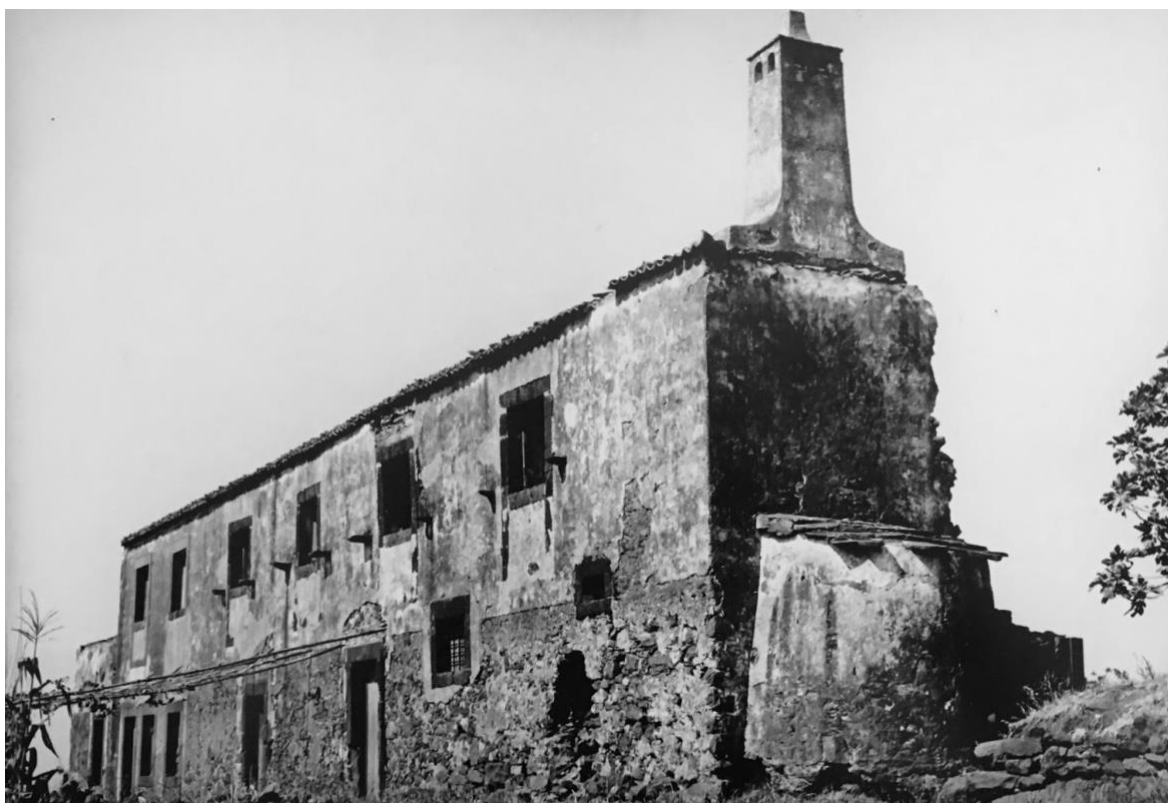
Figura 1 Alçado sul da denominada Casa das Mudás, sítio da Vargem, Calheta, então em adiantado estado de ruína; ostentava uma janela datada de 1759. Foto Rosado, 1970, negativo em película, ABM, COLFOT, n3793
