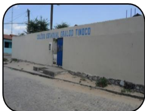
Figura 39 – muro antes das atividades 65
