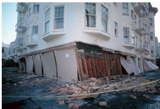
Figura 11 - Colapso parcial de um edifício causado pelo mecanismo de “Soft Storey” – Sismo de Loma Prieta [46]
