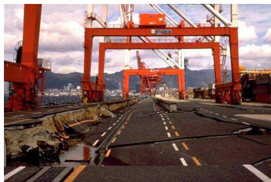
Figura 8 – Danos causados no porto de Port Island, Kobe (1995) por Liquefação dos solos [23]
