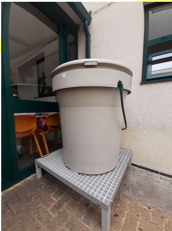
Figura 38- Sistema demonstrativo de armazenamento de água das chuvas para reutilização por rega gota-a-gota em um jardim interior, instalado em 2021 na Universidade da Madeira.
