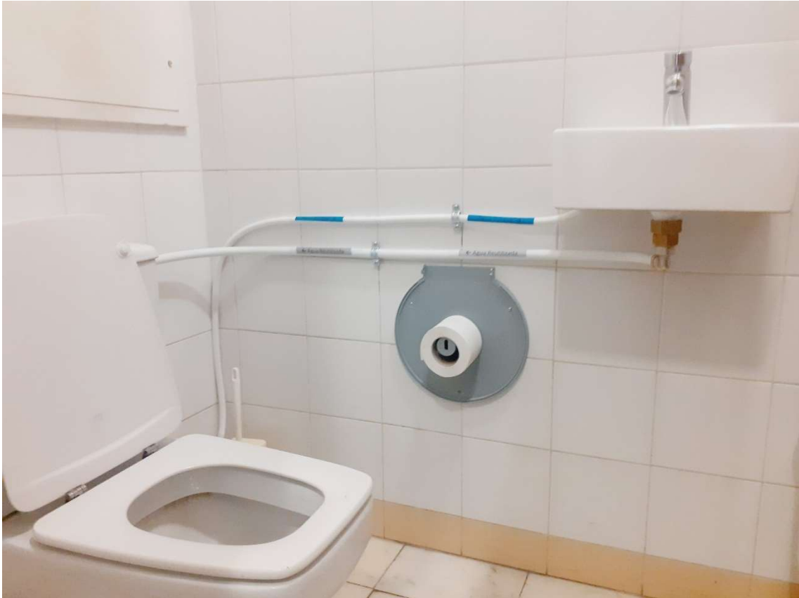
Figura 37- Sistema de reutilização das águas cinzentas provenientes da lavagem das mãos para reutilização na descarga de um autoclismo, instalado em 2021 em uma casa de banho na Universidade da Madeira.
