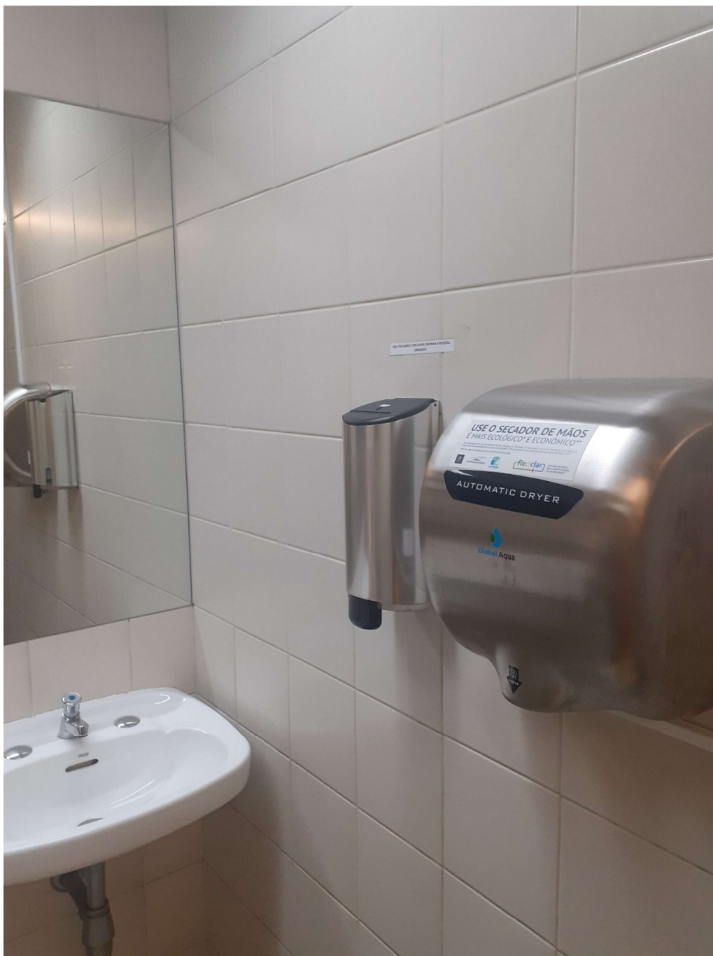
Figura 47- Secadores de mão elétricos foram instalados na Universidade da Madeira nas 12 casas de banho com uso mais frequente. A instalação ocorreu em setembro de 2021 através do projeto Reciclar+UMA.
