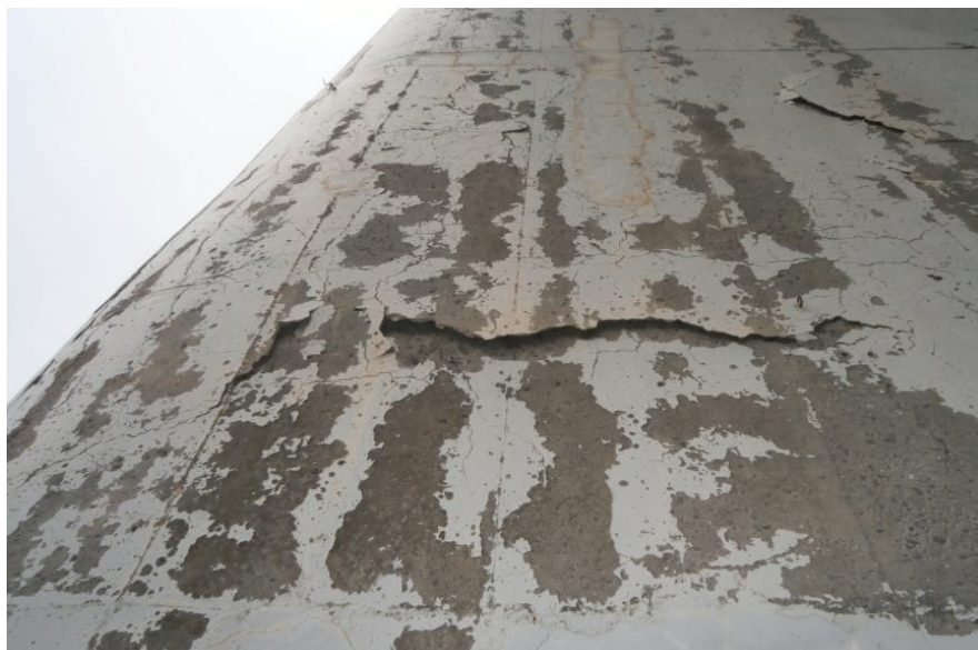
Figura 74: Destacamento do betão.
