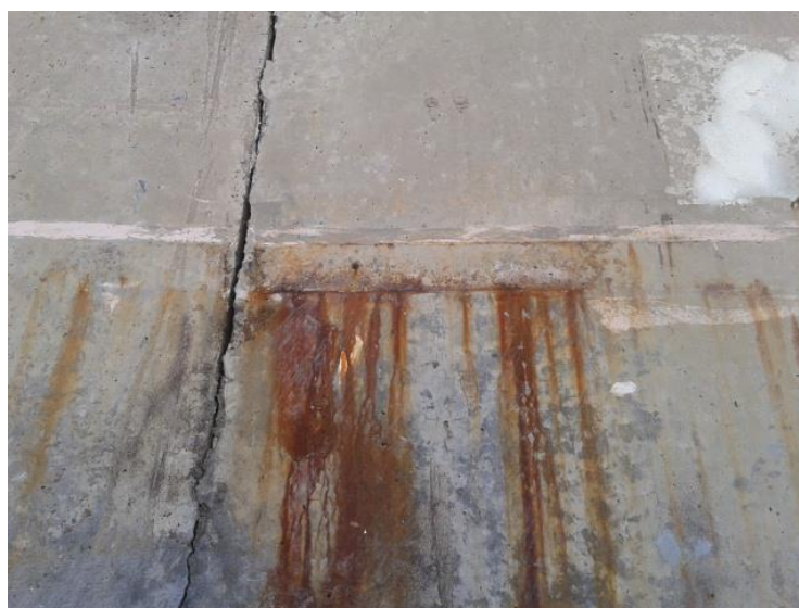
Figura 63: Corrosão em muro do porto de acostagem do Porto Santo.
