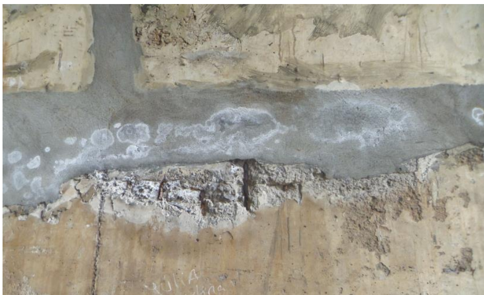
Figura 107: Degradação do interior do túnel.
