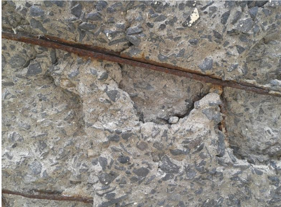
Figura 101: Grande volume de agregados grossos.
