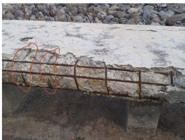
Figura 77: Corrosão total de alguns estribos
