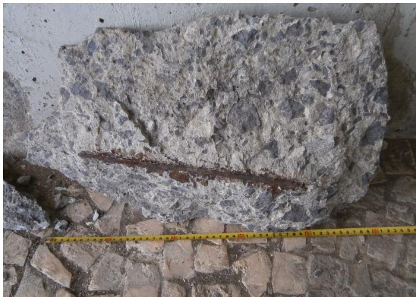
Destacamento de um bloco de betão com armadura incluída.
