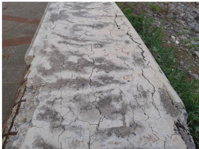
Figura 78: Estado de degradação
