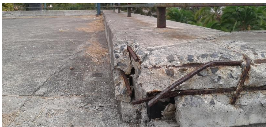
Figura 90: Pormenor do destacamento do betão.
