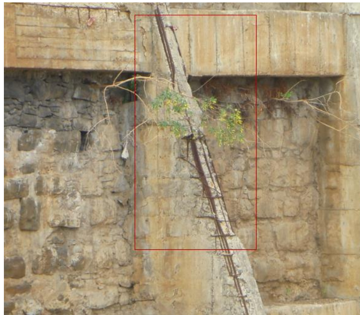
Figura 82: Excesso de varões encostados.
