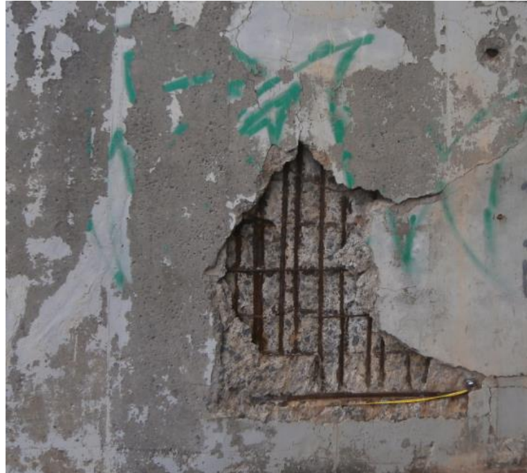
Figura 72: Estado degradado da estrutura.
