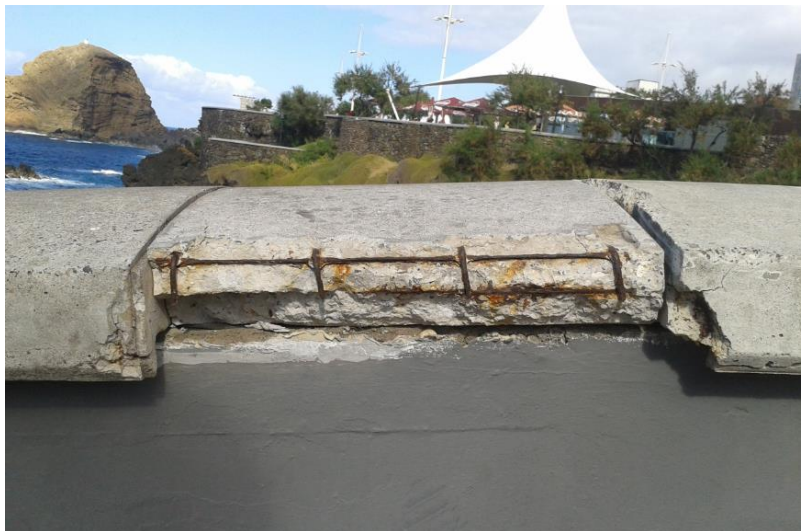
Figura 91: Deterioração do elemento pré-fabricado.
