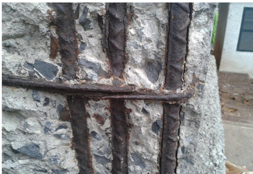
Figura 88: Perda de secção dos estribos.
