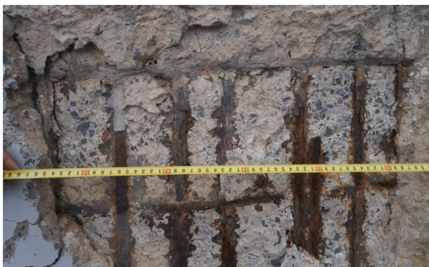
Figura 71: Perda de secção dos varões.
