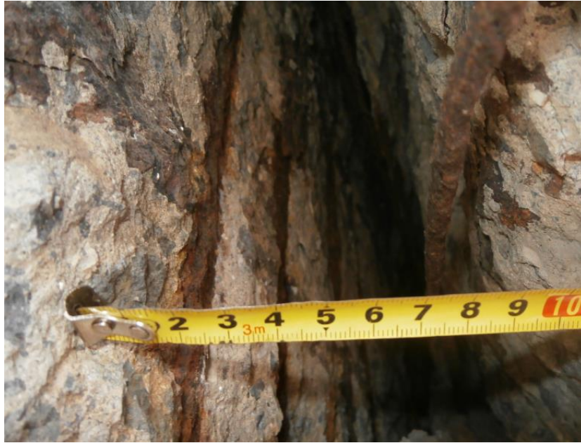
Vazio existente entre revestimento e núcleo do elemento.
