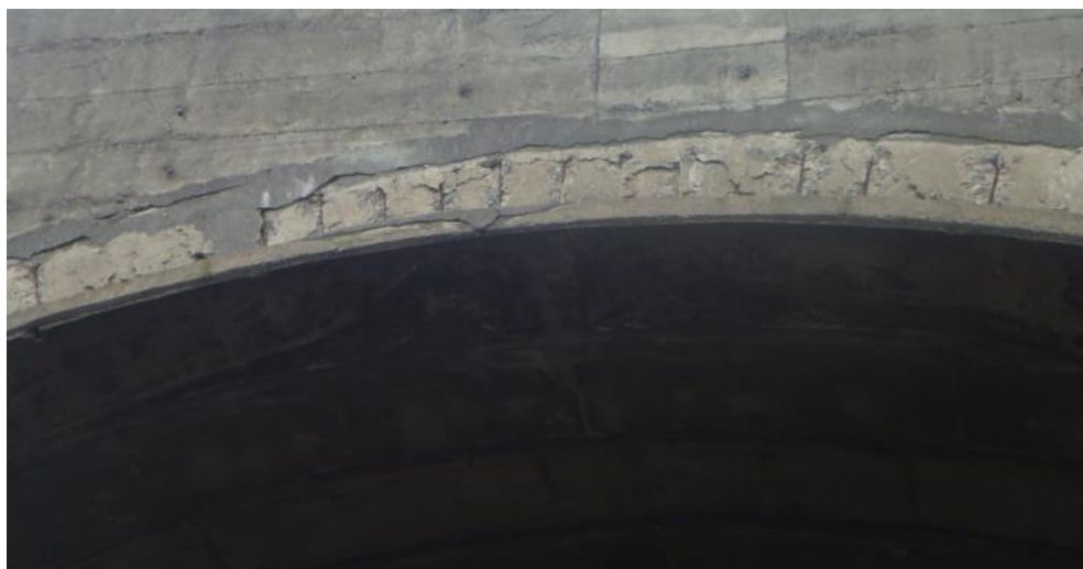
Figura 104: Anomalia no emboquilhamento do túnel da Nazaré.
