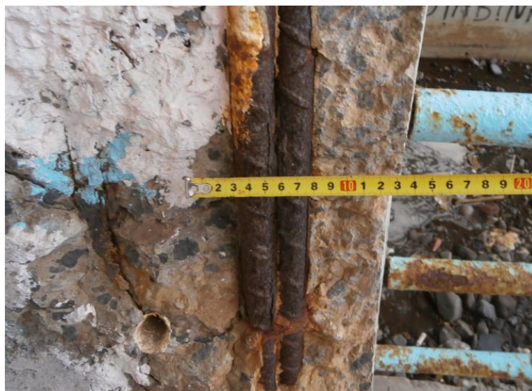
Destacamento de grandes áreas de betão.
