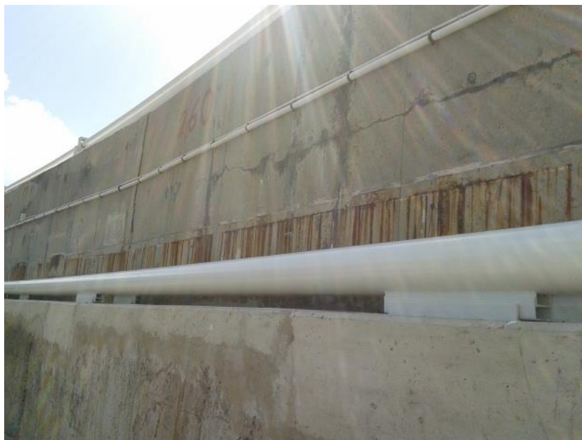
Figura 64: Corrosão em muro do porto de acostagem do Porto Santo.
