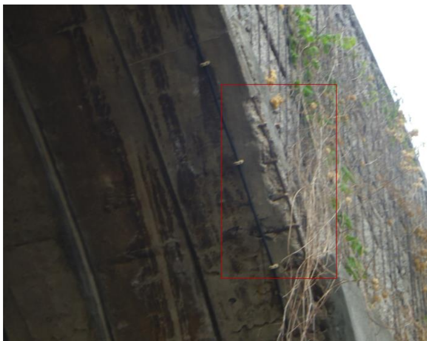
Figura 105: Estado de degradação da viga de emboquilhamento.
