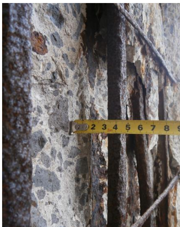
Afastamento das armaduras do núcleo do elemento, e perda de secção do varão.
