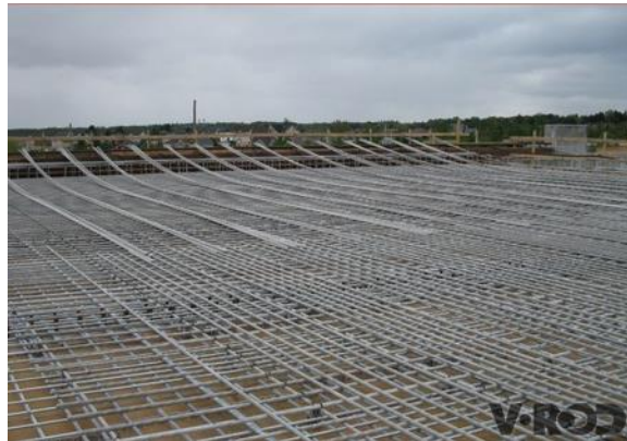
Figura 44: Instalação dos varões no tabuleiro da ponte da Highway 410, extraído de www.vrod.ca .
