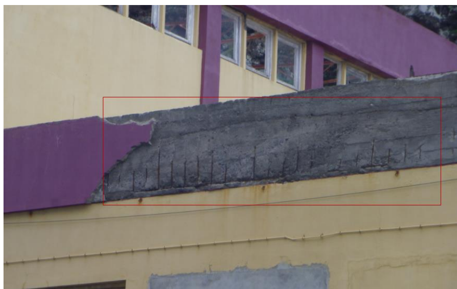
Figura 96: Defeito de construção na estrutura.
