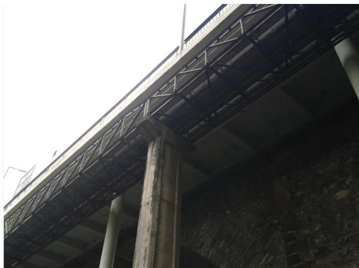
Figura 86: Estrutura de suporte das instalações técnicas.
