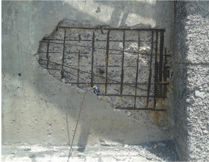
Figura 98: Estado do muro de suporte.
