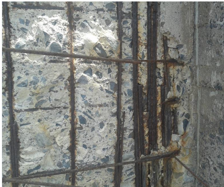
Figura 99: Pormenor do estado dos varões.
