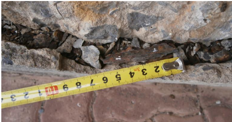
Tamanho dos produtos de corrosão dos varões em aço.
