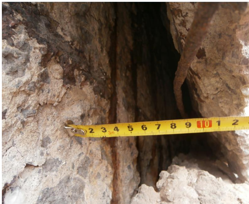
Figura 73: Destacamento do betão de recobrimento.
