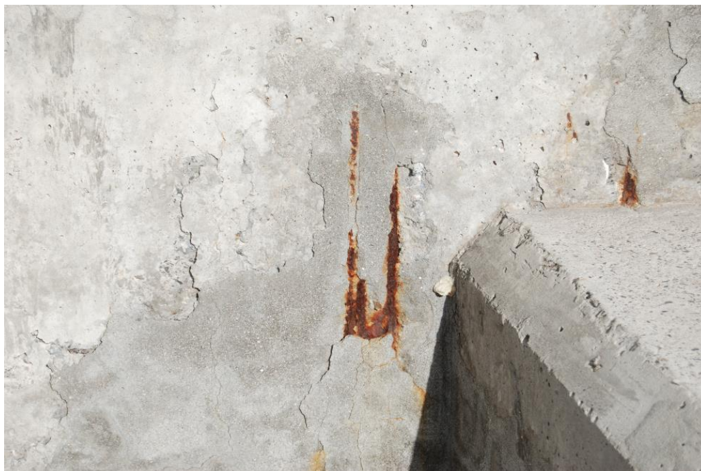
Figura 62: Corrosão de armaduras por falta de recobrimento.
