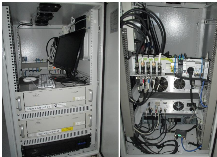
Figura 27: Bastidor na estação da Biblioteca Municipal de Câmara de Lobos.
