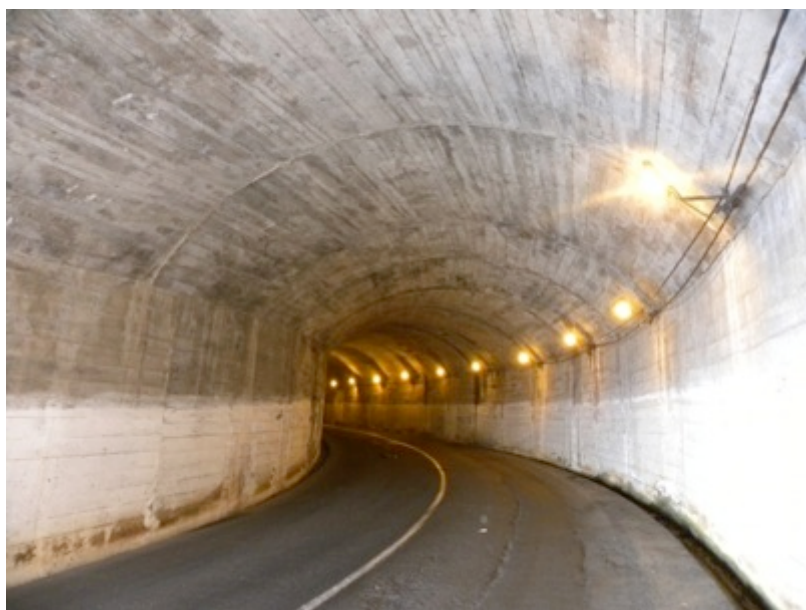
Figura 43 – Revestimento Túnel II, junto ao emboquilhamento sul, na zona do acidente de 1968
