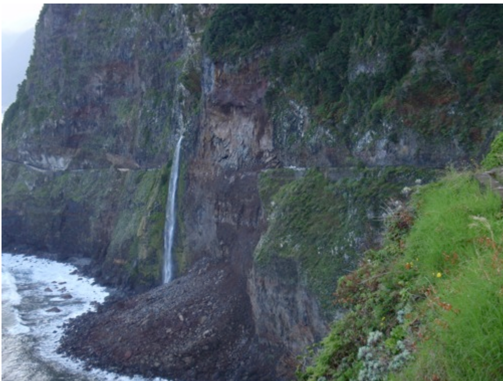
Figura 33 – Vista para este após derrocada de 2008 (RAMEDM, s.d.)
