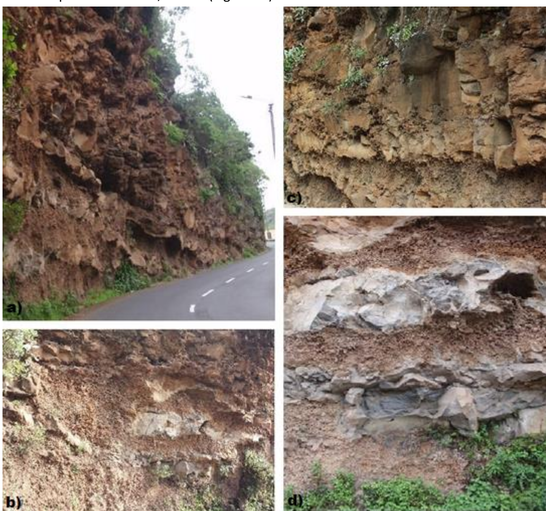
Figura 28 - Características do talude A : a) Perspetiva geral do talude A ; b) Zonas deprimidas ao longo dos níveis de brechas; c) Predominância das formações basálticas sobre as brechas; d) Brechas intercaladas com basalts.
