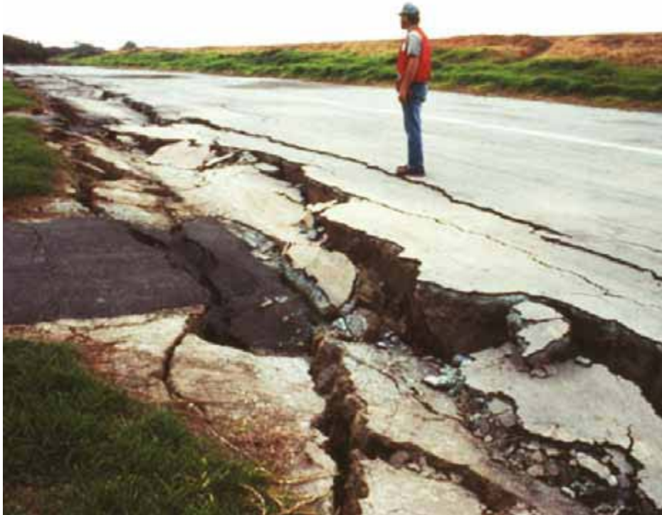
Figura 11- Fotografia de um espalhamento lateral ocorrido em uma rodovia, como resultado do terremoto Loma Prieta, em 1989, na Califórnia, EUA. (Fotografia por Steve Ellen, U.S. Geological Survey). (Fonte: Highland & Bobrowsky,2008)
