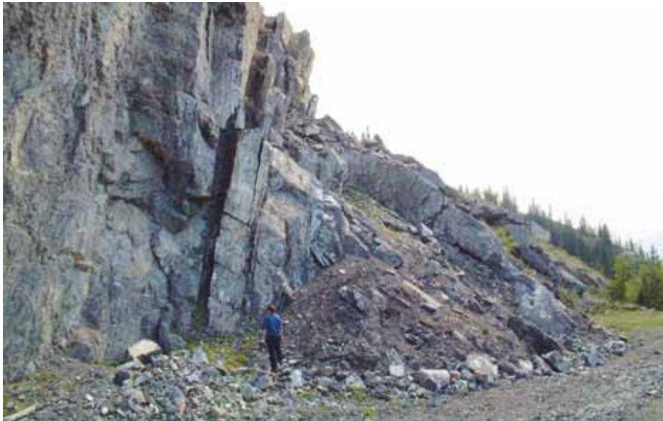
Figura 5- Fotografia de um bloco envergando em Fort St. John, British Columbia, Canadá. (Foto por G. Bianchi Fasani) (Fonte: Highland & Bobrowsky,2008)
