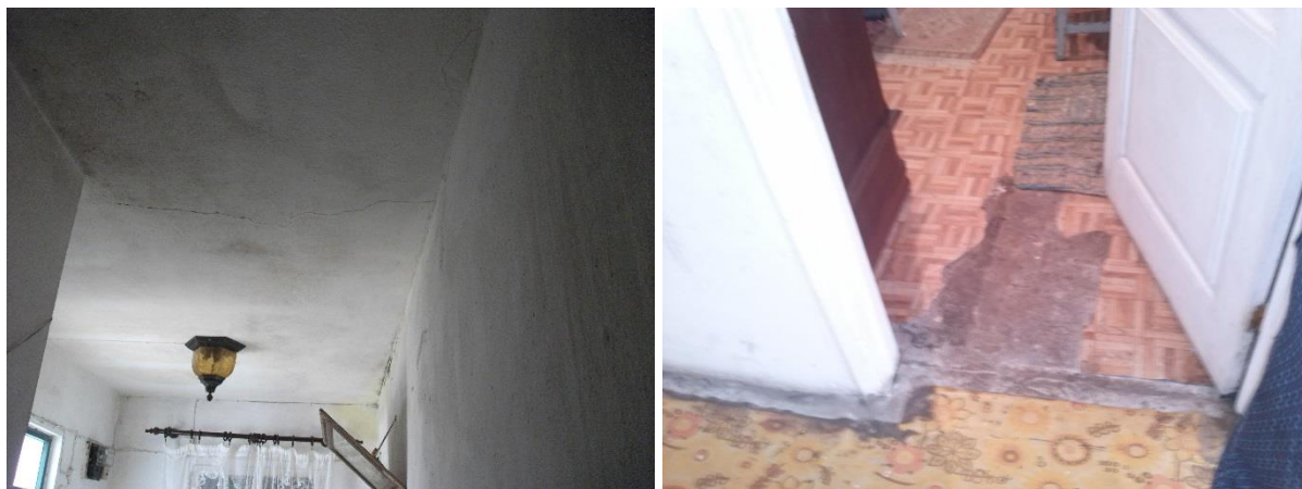
Figura 48: Estado das paredes e teto do corredor (à esquerda) e do pavimento do quarto 1 (à direita)
