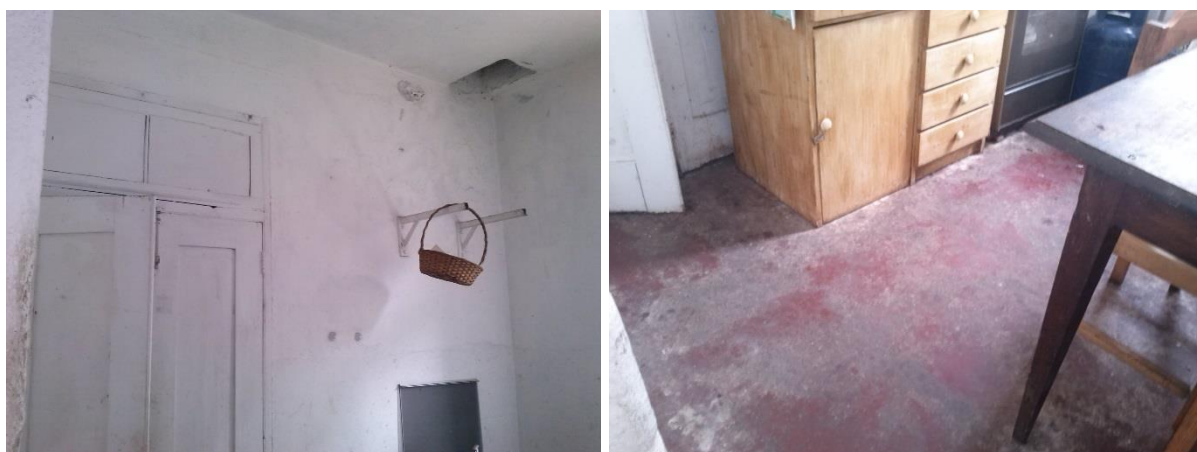
Figura 47: Estado atual das paredes da cozinha (à esquerda) e estado atual do pavimento (à direita)
