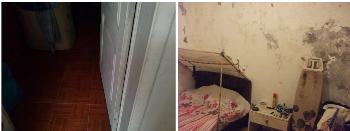
Figura 50: Estado atual do pavimento no quarto 2 (à esquerda) e estado atual da pintura das paredes do quarto 4 (à direita)
