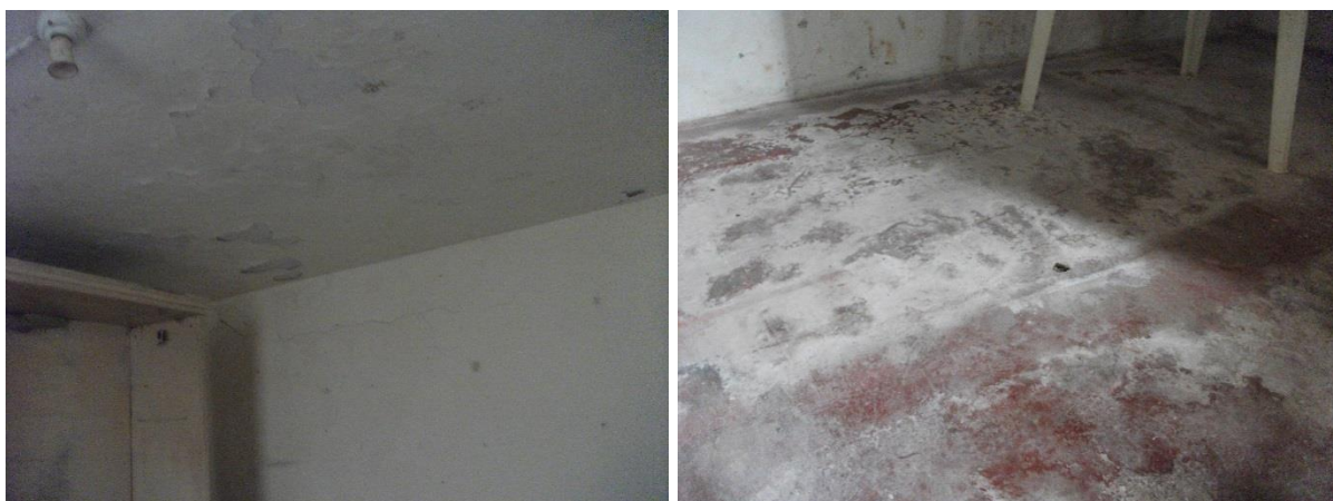
Figura 54: Estado de degradação do quarto 5, teto e paredes (à esquerda) e pavimento (à direita)
