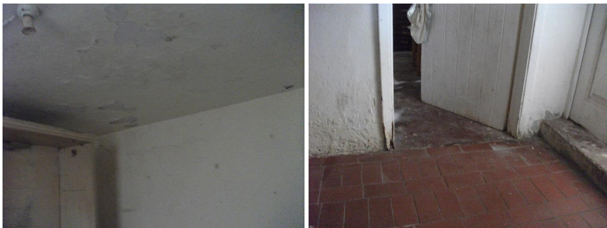
Figura 53: Estado de degradação da cozinha 2, teto e paredes (à esquerda) e pavimento (à direita)
