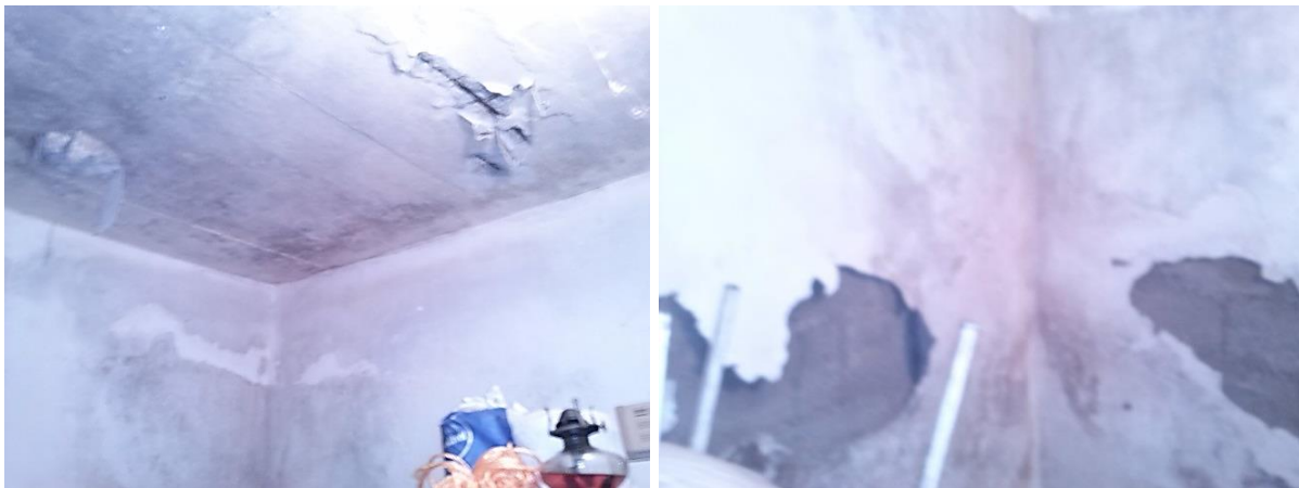
Figura 24: Teto da arrecadação (à esquerda) e reboco das paredes da arrecadação (à direita)
