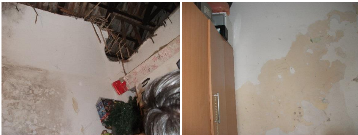
Figura 17: Quarto 2 em degradação (à esquerda) e estado do quarto 3 (à direita)
