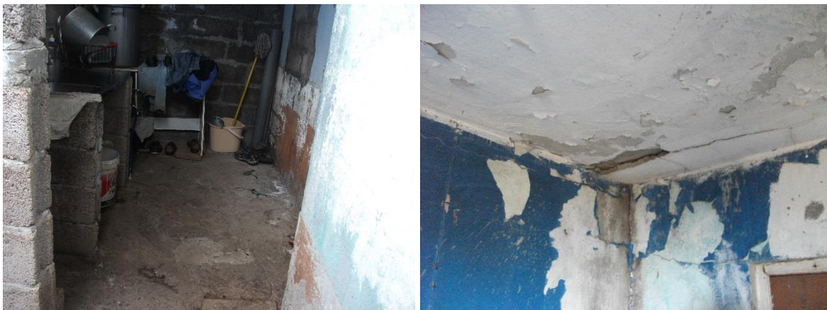
Figura 52: Estado atual da lavandaria (à esquerda) e estado de degradação da arrecadação (à direita)
