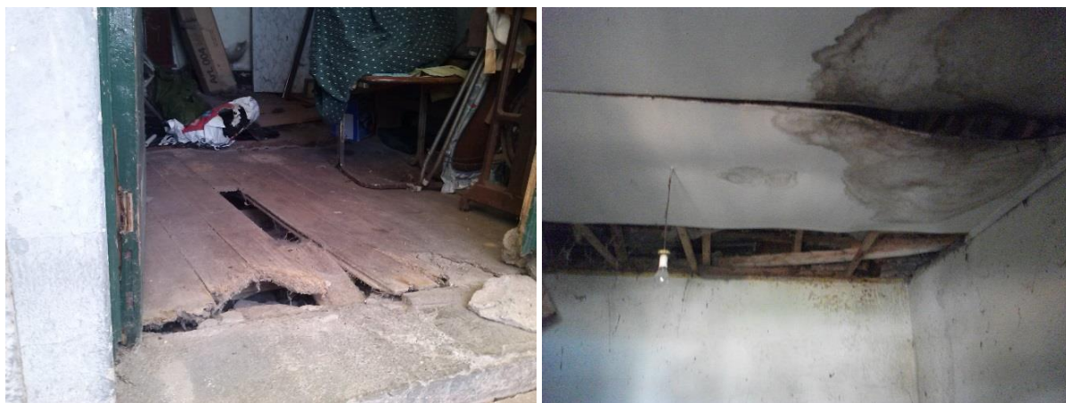
Figura 23: Estado atual do pavimento da sala (à esquerda) e estado do teto falso do quarto (à direita)
