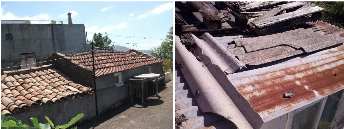
Figura 34: Cobertura em telhado (à esquerda) e paredes em estado de degradação (à direita)
