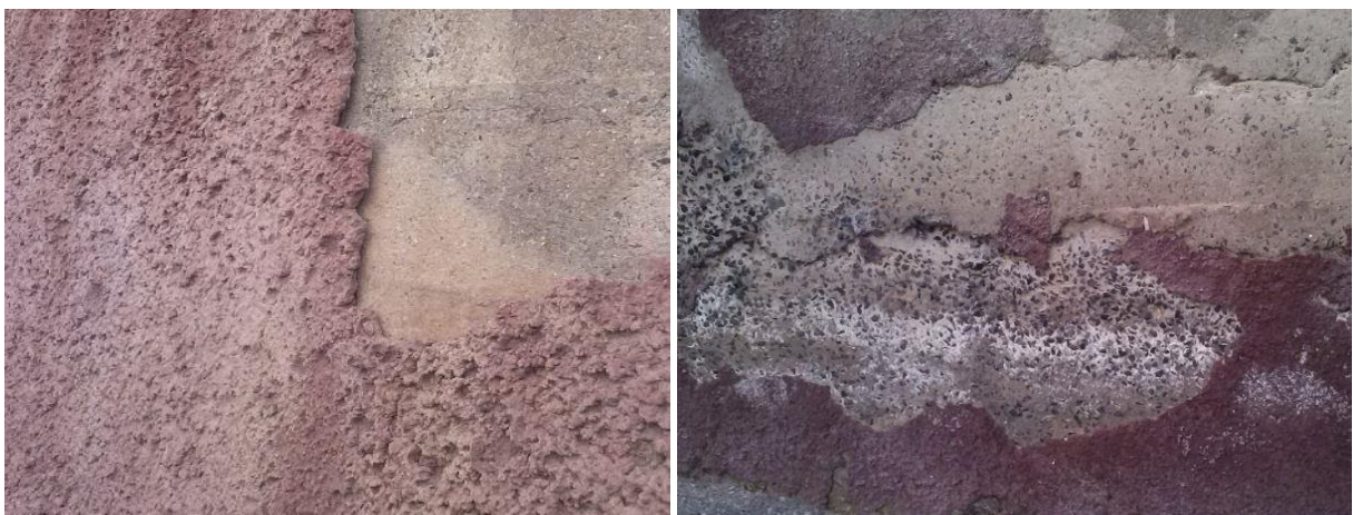
Figura 5: Aderência do revestimento insuficiente (à esquerda) e resistência do suporte insuficiente (à direita)
