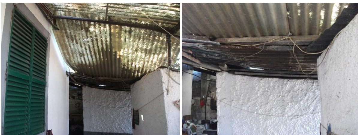
Figura 21: Cobertura da cozinha e da casa de banho (à esquerda) e da zona de apoio à cozinha (à direita)
