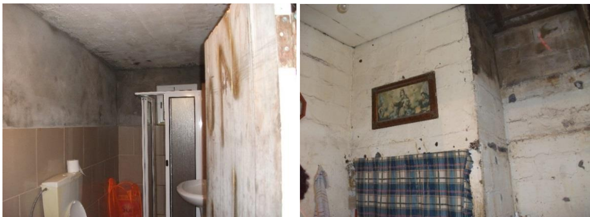
Figura 16: Estado atual da casa de banho (à esquerda) e quarto 1 com infiltrações e condensações (à direita)
