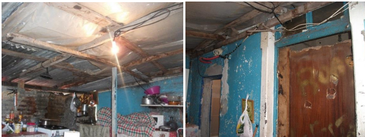
Figura 15: Estado atual da cozinha (à esquerda) e estado de conservação das portas exteriores (à direita)
