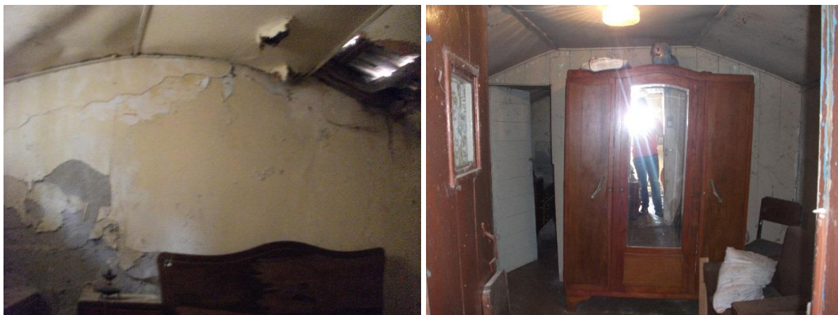
Figura 37: Quarto 5 em degradação (à esquerda) e estado da sala 2 (à direita)
