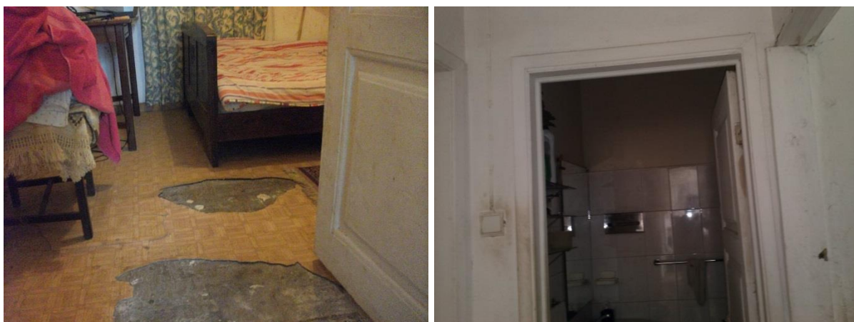
Figura 51: Estado atual do pavimento no quarto 4 (à esquerda) e estado atual da casa de banho (à direita)
