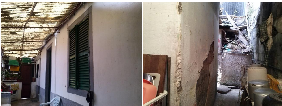
Figura 22: Revestimento do alçado principal (à esquerda) e revestimento do alçado lateral esquerdo (à direita)
