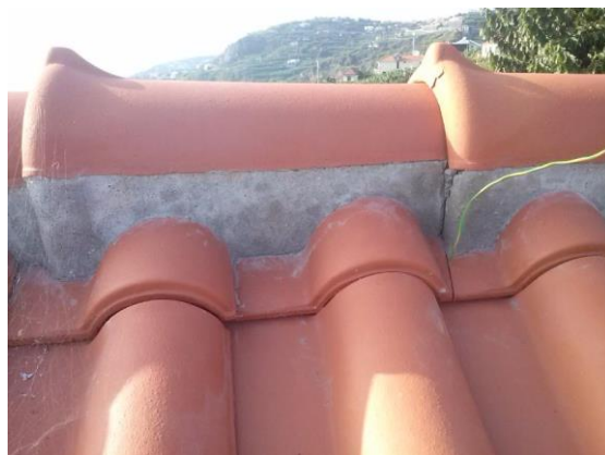
Figura 10: Cumeeira em rotura devido ao excesso de argamassa utilizada na sua execução
