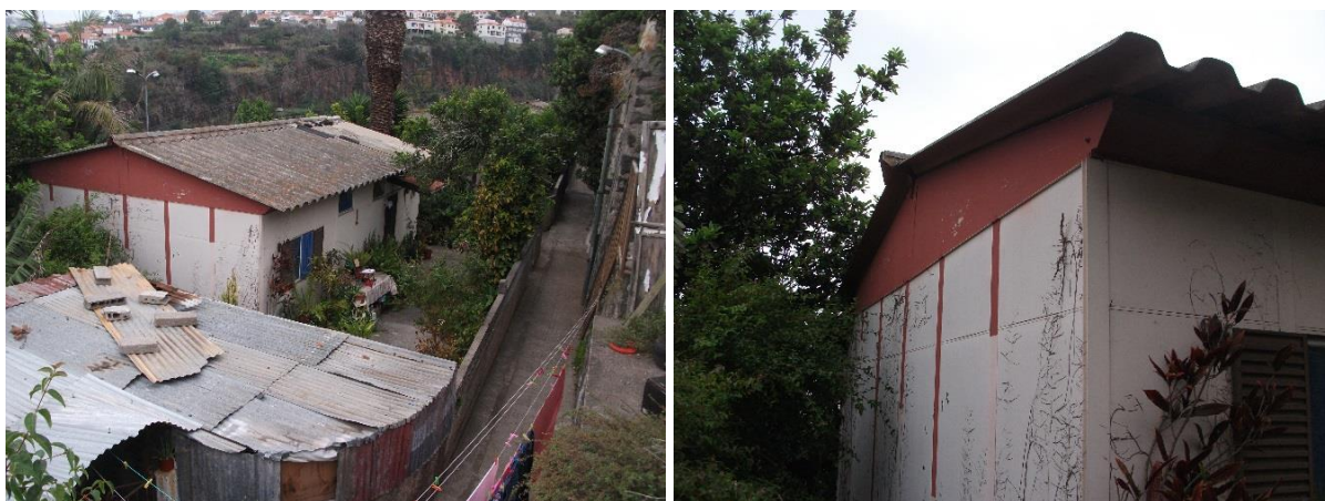
Figura 28: Cobertura em terraço (à esquerda) e estado de degradação das fachadas (à direita)
