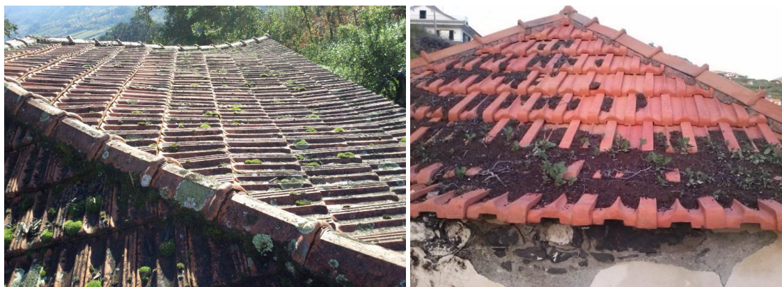
Figura 8: Telhado com acumulação de sujidades devido a inclinação insuficiente (à esquerda) e revestimento degradado devido ao mau funcionamento do telhado (à direita)
