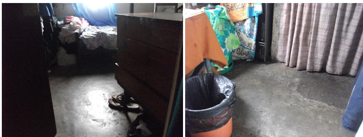
Figura 30: Estado atual do pavimento do quarto (à esquerda) e estado do pavimento da cozinha (à direita)
