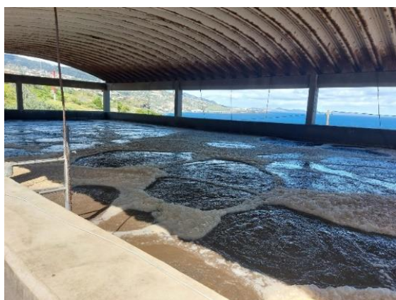
Figura 4 - ETAR de Gaula: Tanque de arejamento Fonte: Elaboração própria
