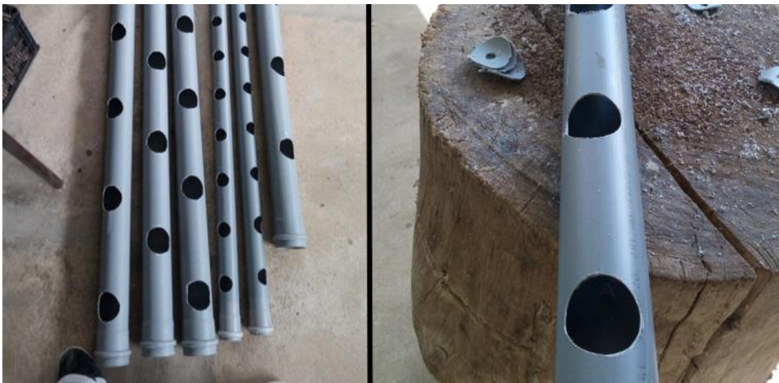
Figura 24. Resultado dos furos nos tubos de PVC.
