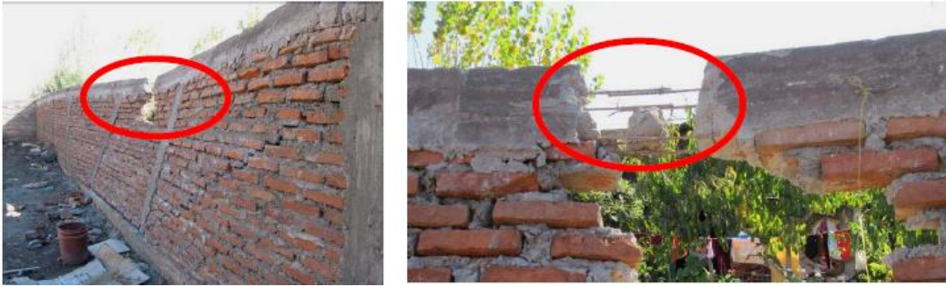
Figura 2-12. Colapso de uma parede em Maule, Chile 2010 (Meli e Brzev (2011)).
