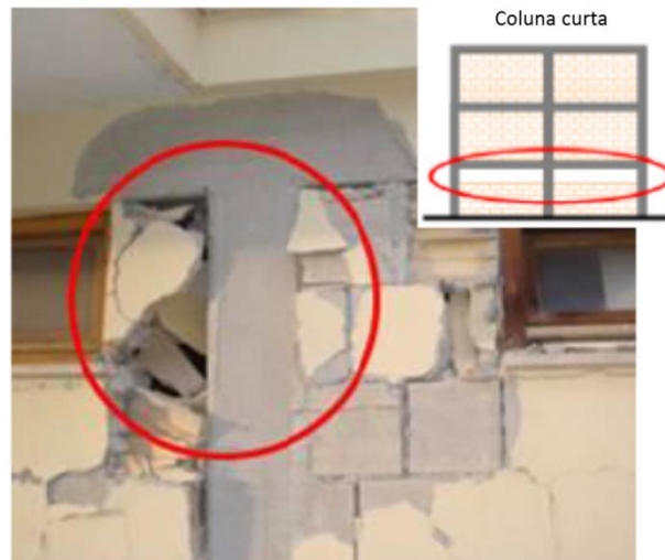
Figura 2-2. Rotura por corte dum pilar perto duma abertura (Varum et al. (2011)).
