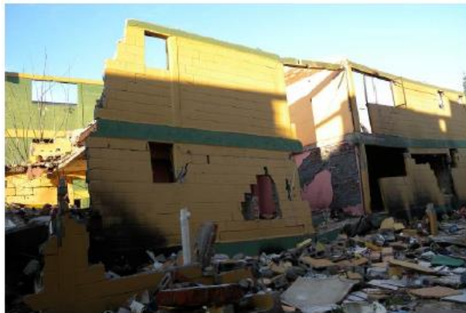
Figura 2-14. Colapso de edificações após o sismo de 2010 em Santa Cruz, Chile (Meli e Brzev (2011)).
