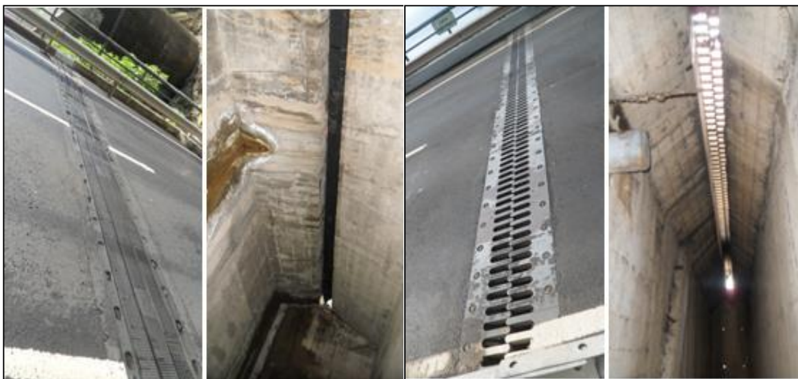
a. Módulos de neoprene, na ponte João Gomes
