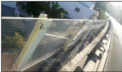
a. Fibras de vidro, no viaduto do Comboio
