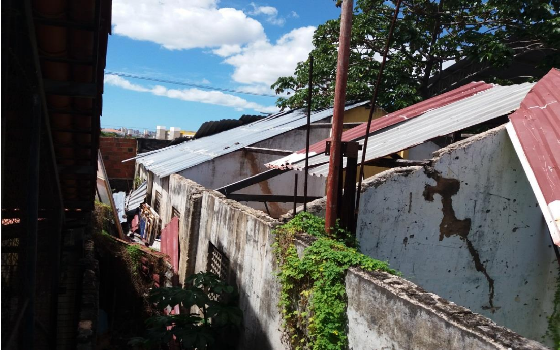
FOTO 7 - FERRO VELHO QUE SEPARA A ESCOLA DA QUADRA COBERTA
