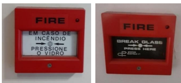
Figura 27. Alarme de incêndio 1 – Campus Universitário da Penteadá, Piso 01.
