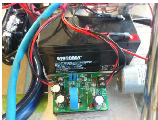
Figura 5.28 – Bateria de 12 V com 7 Ah, e o regulador 12-15V DC .
