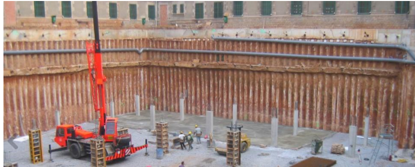
Figura 22 - Contenção periférica de cortina de estacas moldadas com ancoragens, em Barcelona (ZeroInfinito, 2010)
