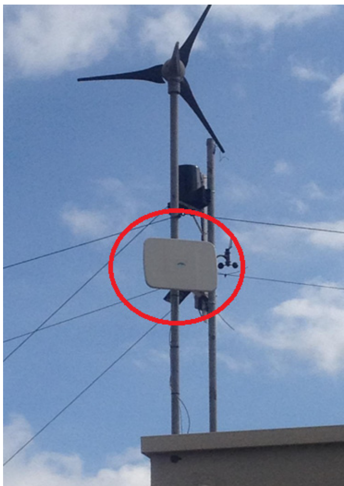
Figura 5.2 - Instalação da antena de feixes hertzianos no edifício da UMa.
