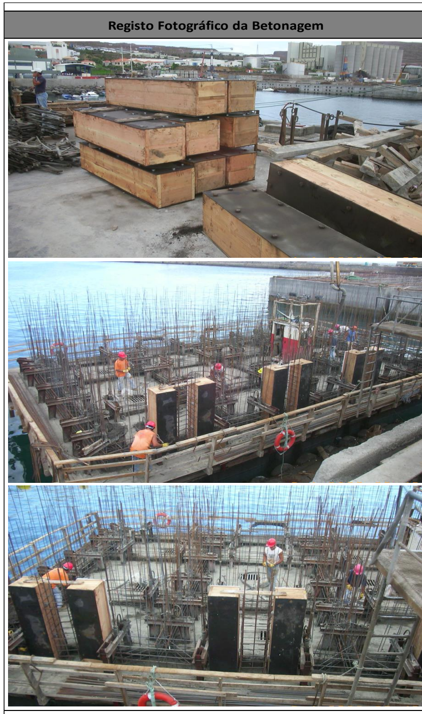
Figura 65 - Excerto da ficha técnica – Betonagens de pré-fabricados (Porto do Caniçal - Rampa Ro-Ro).
