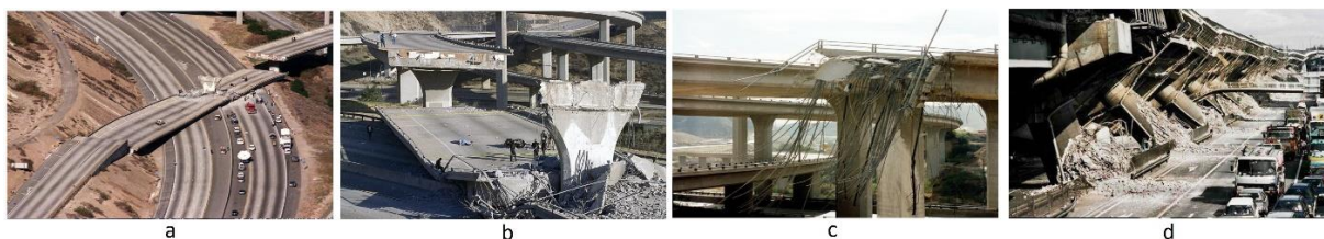
Figura 1.1 – Pontes colapsadas no sismo de Northridge por deslocamentos excessivos nas juntas: (a) e (b) Ponte 1 (estrutura original); (c) Ponte 2 (estrutura com cabos de aço – colapso por rotura dos cabos). (d) Ponte colapsada no sismo de Kobe por acumulação de grandes deslocamentos residuais nas colunas de betão armado
