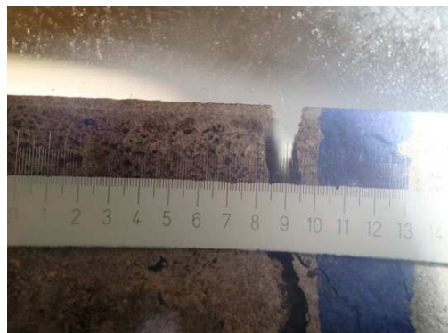
Figura 4.71 - Abertura de fendas no apoio central da viga G3-a na carga de 40 kN
