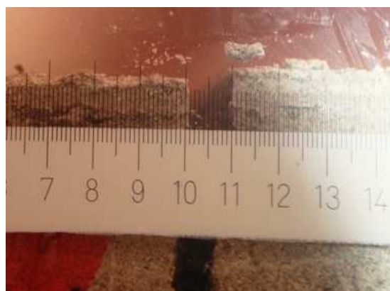
Figura 4.17 - Medição da abertura da fenda no apoio central para a carga de 43 kN
