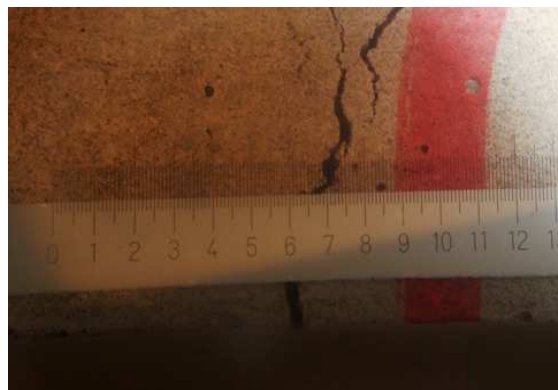
Figura 4.30 – Abertura de fendas no vão esquerdo da viga G1-a para a carga de 23 kN
