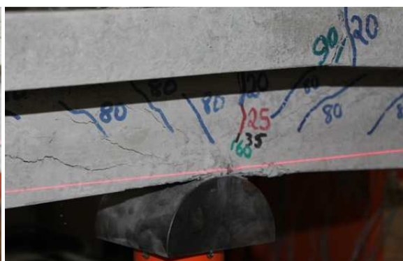
Figura 4.64 – Estado do apoio central da viga G3-b
