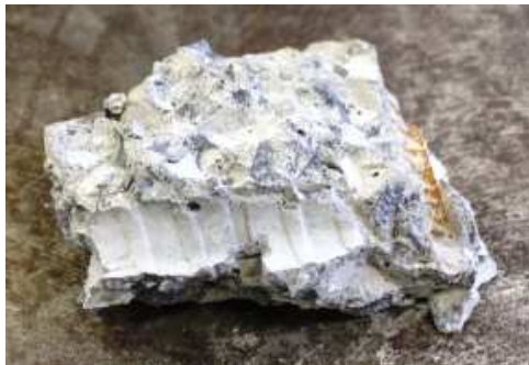
Figura 4.69 - Fragmento de betão do vão da viga G3-b
