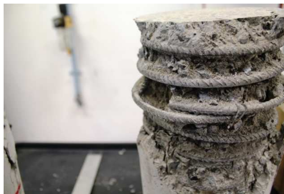
Figura 4.7 - Quebra da amarração do estribo
