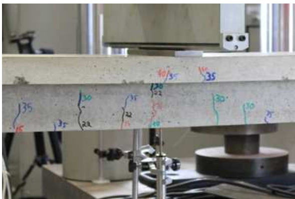
Figura 4.52 - Padrão de fissuras no vão esquerdo da viga G2-a para a carga de 40 kN
