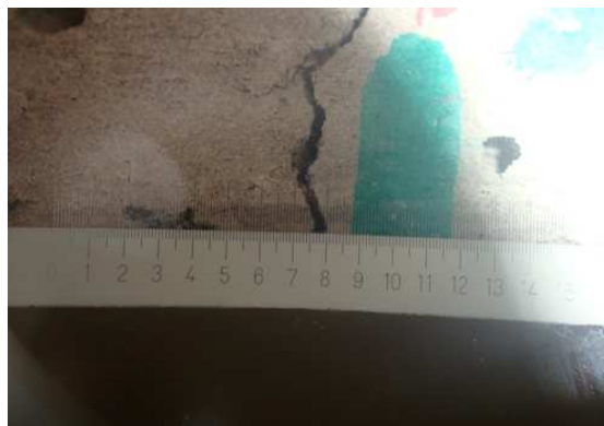
Figura 4.51 - Abertura de fendas no vão direito da viga G2-a na carga de 40 kN
