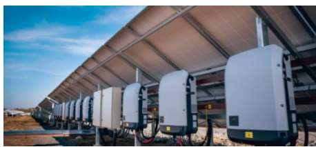
Figura 2.23. Aplicação dos microinversores [58].
