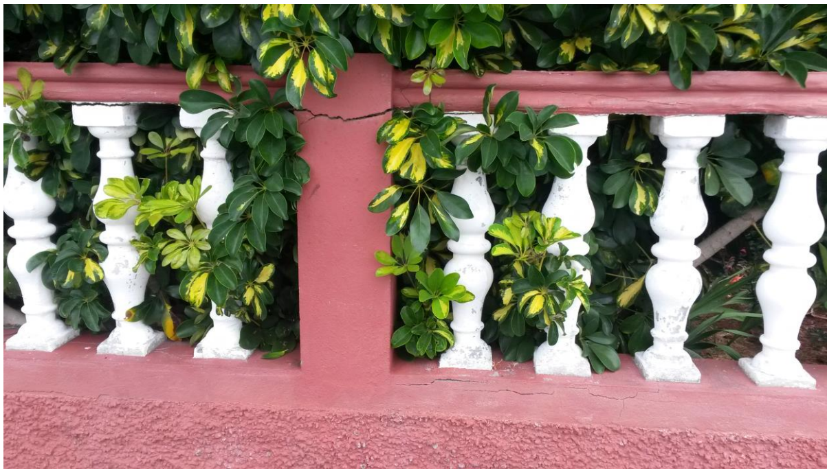
Figura 4.27 – Fendilhação do suporte do corrimão e da base dos balaústres
