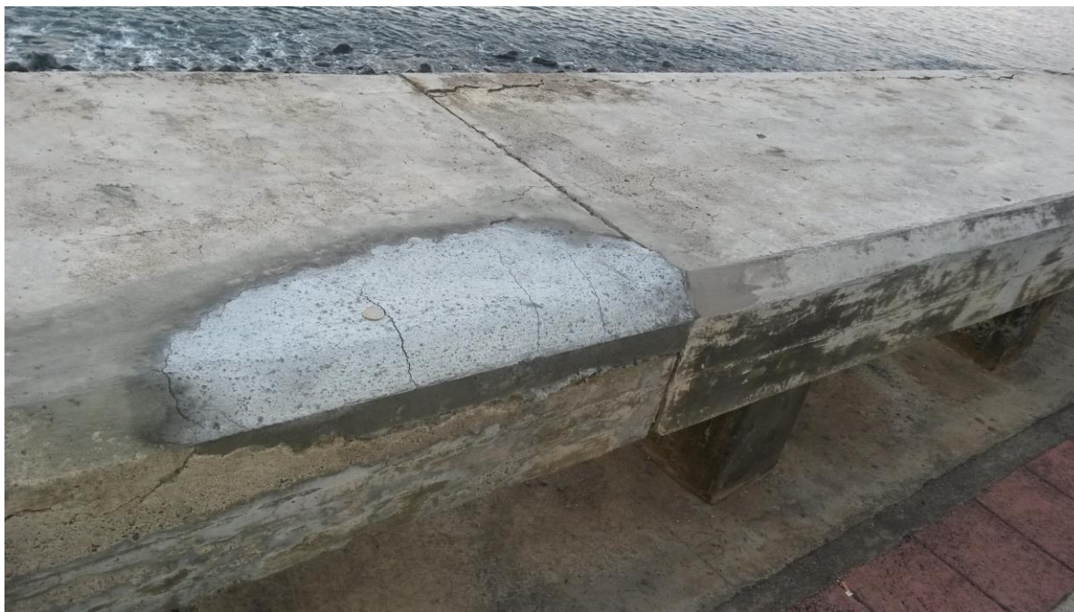
Figura 4.31 – Reparação de betão armado mal efetuada
