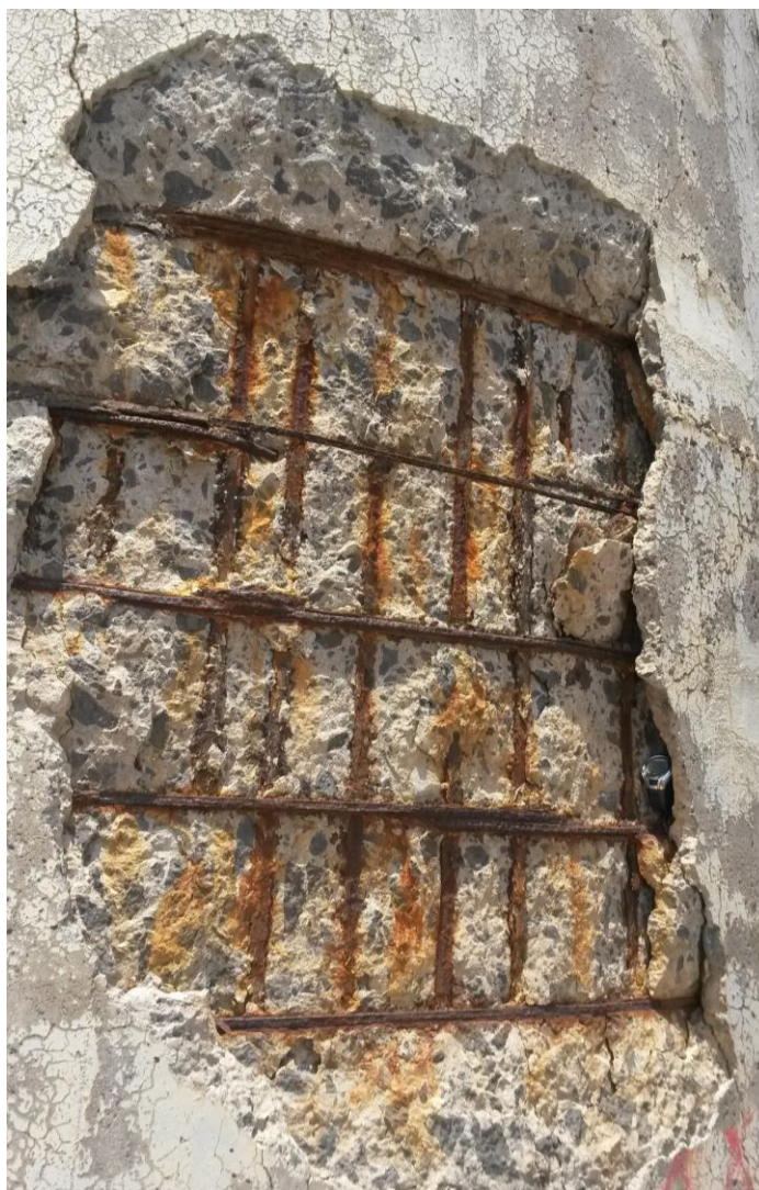
Figura 2.18 – Exposição das armaduras devido à delaminação do betão
