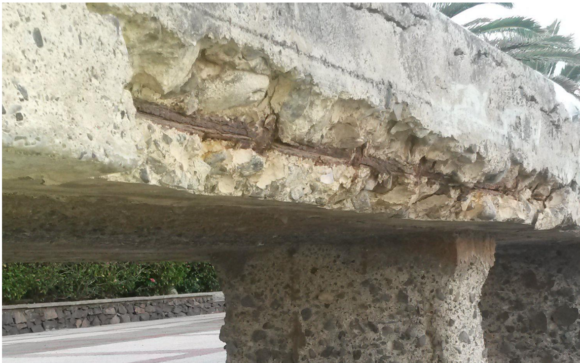
Figura 4.36 – Heterogeneidade do betão no elemento estrutural
