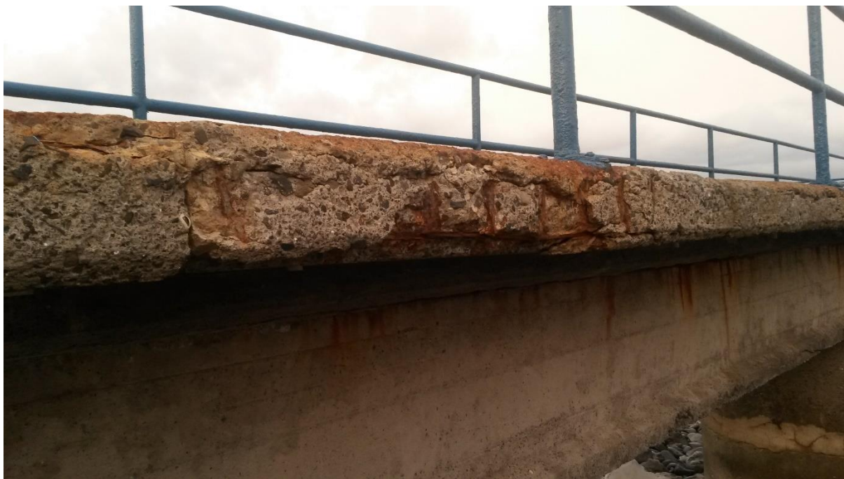
Figura 4.42 – Má colocação das armaduras numa laje junto ao mar
