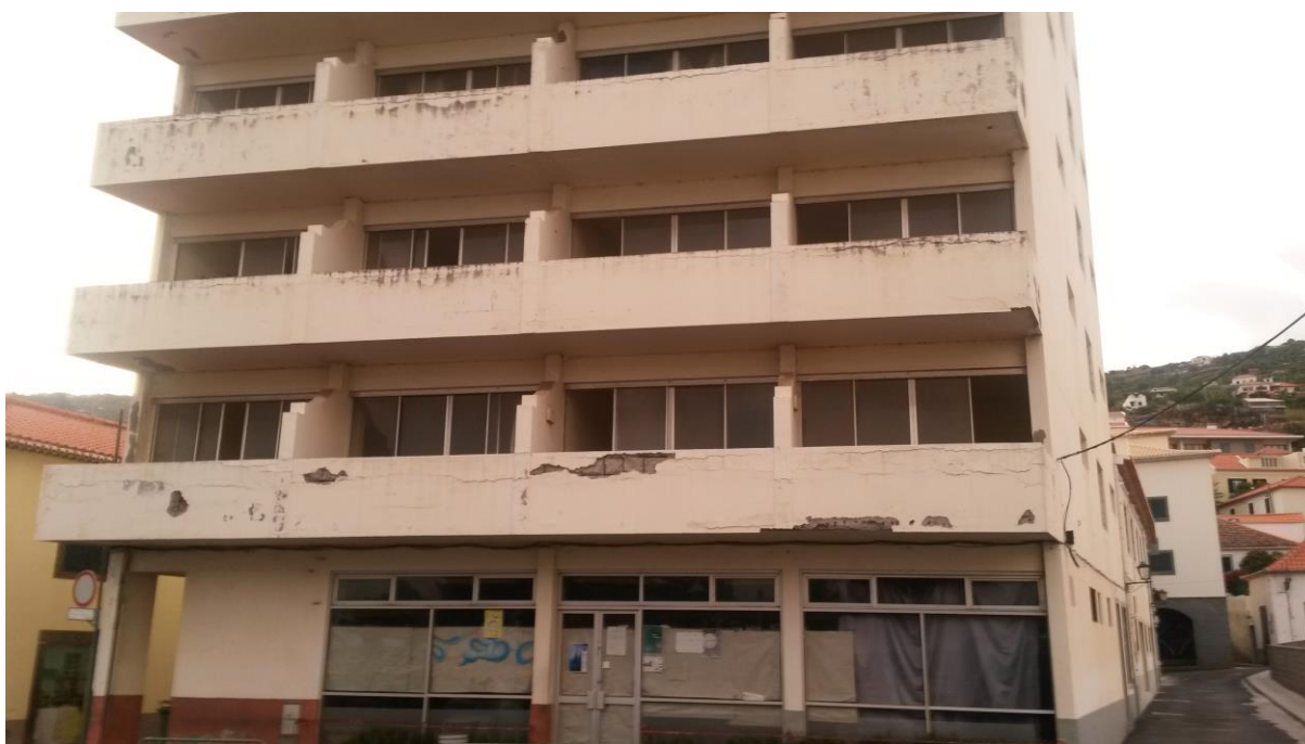
Figura 4.37 – Edifício em degradação
