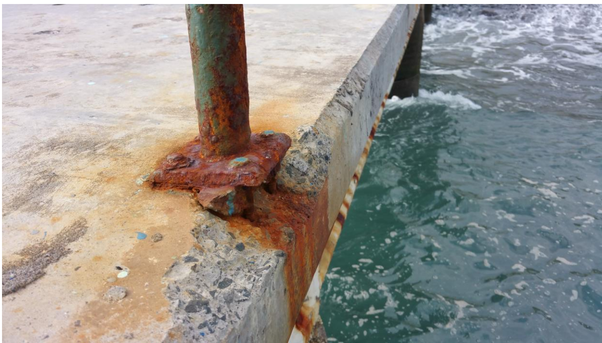
Figura 4.12 – Suporte de fixação de uma varanda junto ao mar
