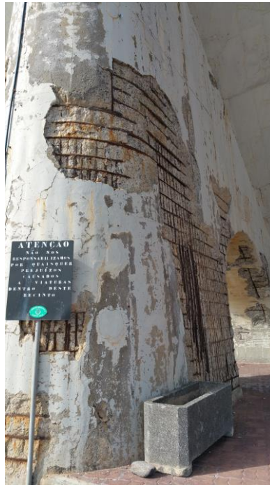
Figura 4.50 – Degradação dos pilares
