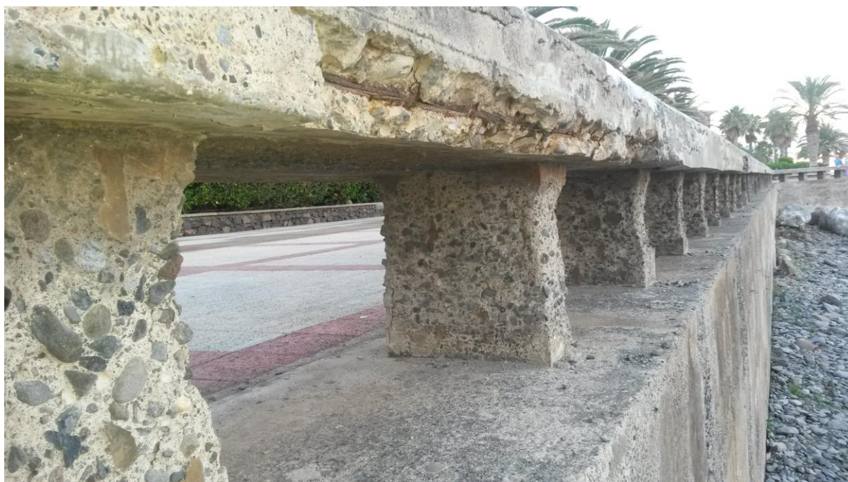
Figura 2.19 – Desagregação e erosão do betão
