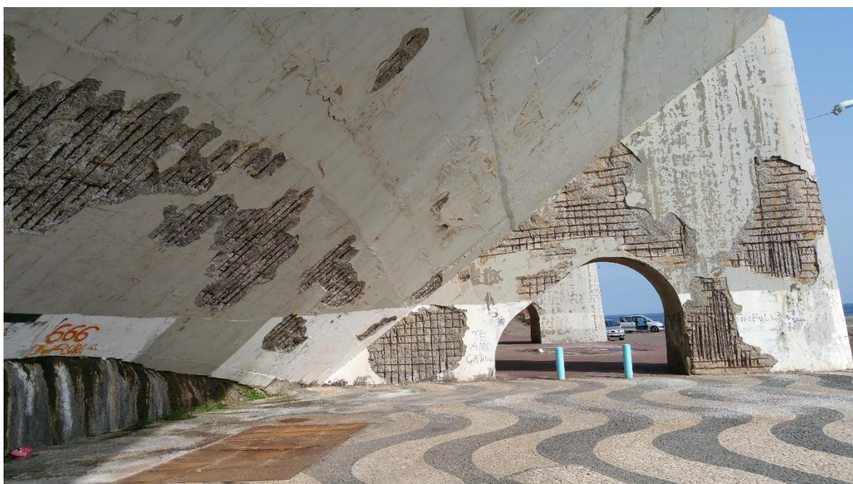
Figura 4.49 – Degradação dos pilares e da laje de suporte do aterro
