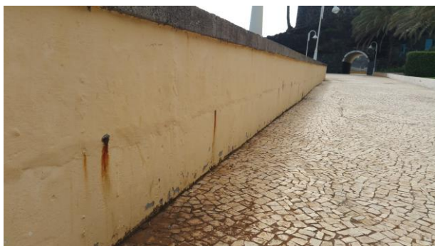
Figura 4.1 – Resultado de uma deficiente cofragem
