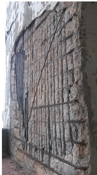
Figura 4.53 – Degradação dos pilhars
