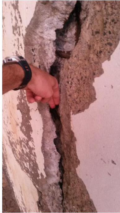
Figura 4.54 – Degradação dos pilhars
