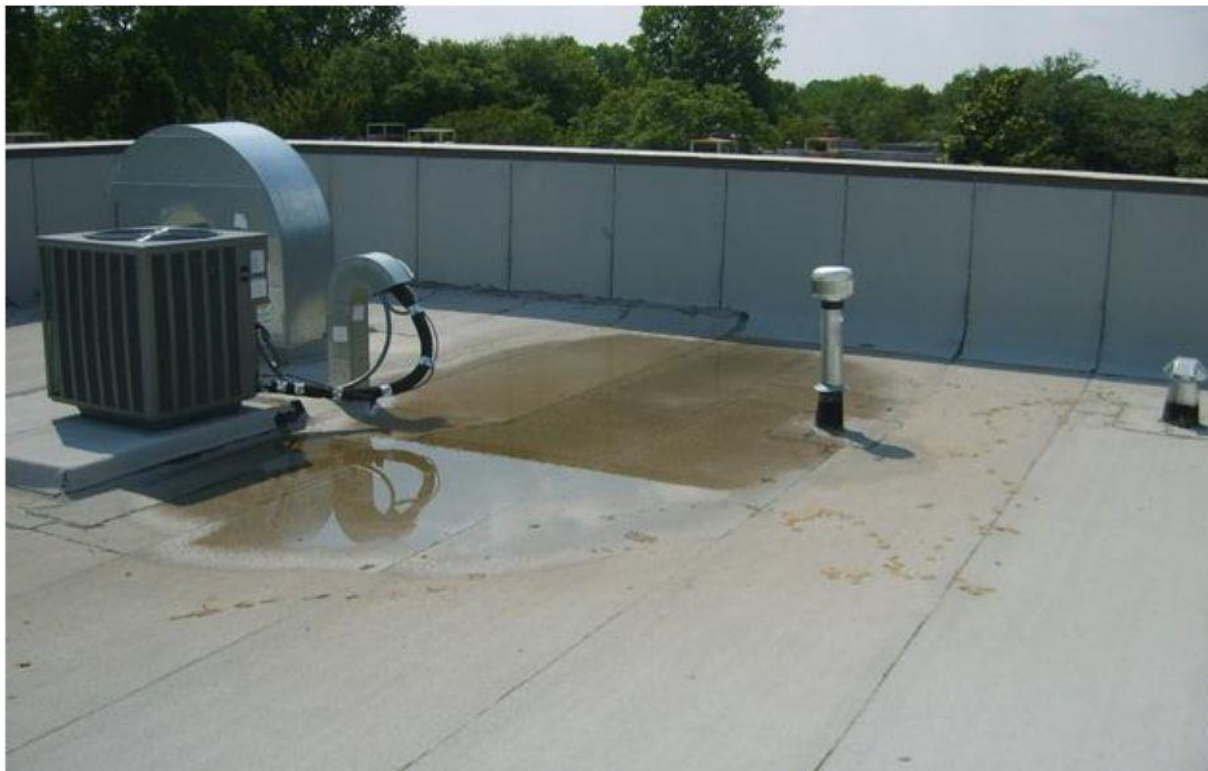
Figura 2.21 – Acumulação de água devido a deformações na laje (53)
