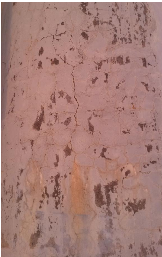
Figura 2.17 – Aceleração da corrosão das armaduras devido à fendilhação do betão
