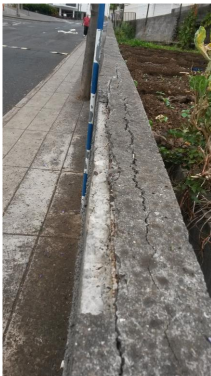
Figura 4.19 – Fendilhação do recobrimento em todo o muro
