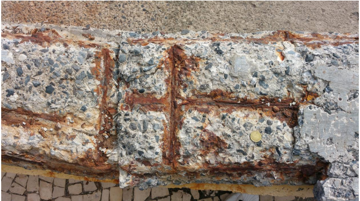
Figura 4.10 – Armaduras de uma peça de betão armado em degradação acelerada
