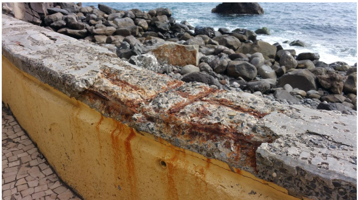
Figura 4.8 – Degradação acelerada de uma peça de betão armado
