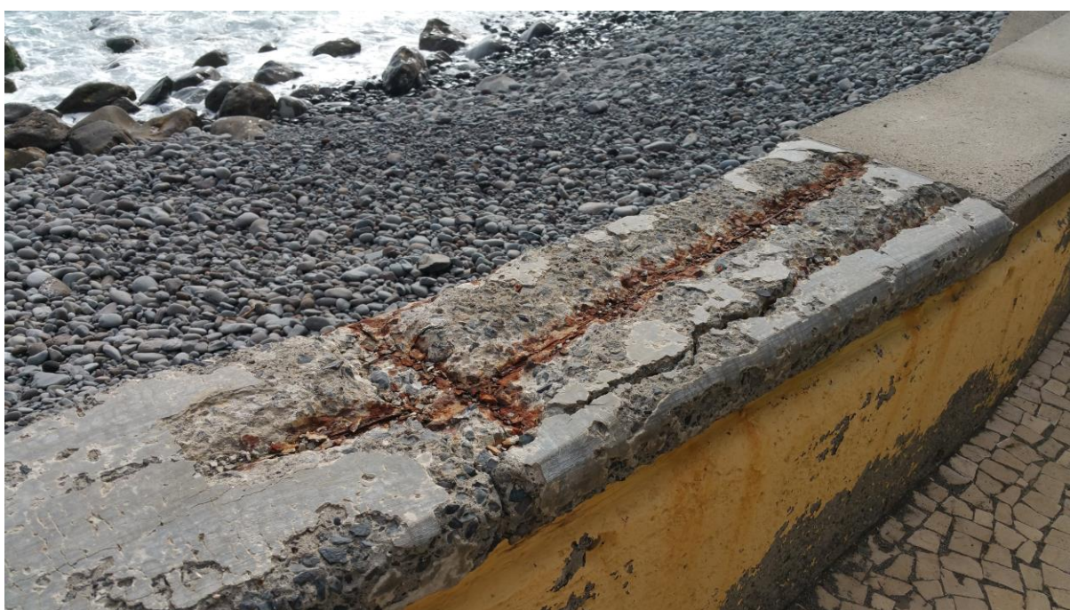
Figura 4.9 – Degradação acelerada de uma peça de betão armado
