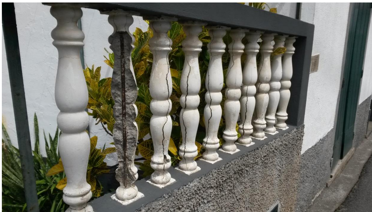
Figura 4.29 – Fendilhação e descolamento do betão em balaústres
