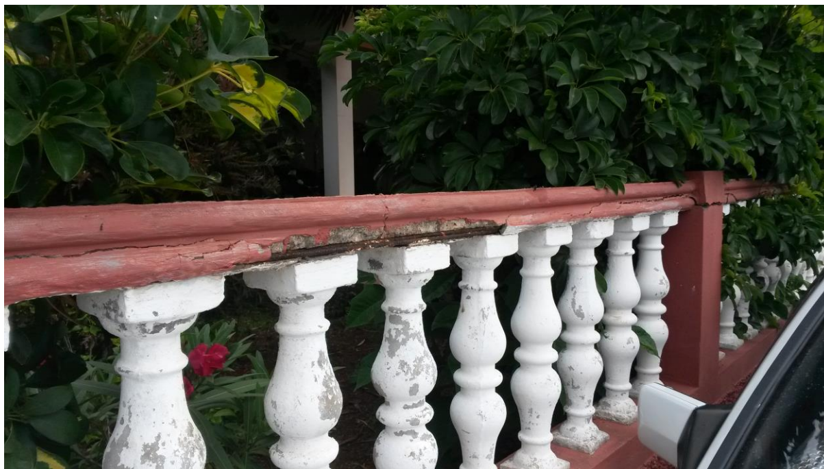
Figura 4.23 – Fendilhação numa varanda devido à corrosão
