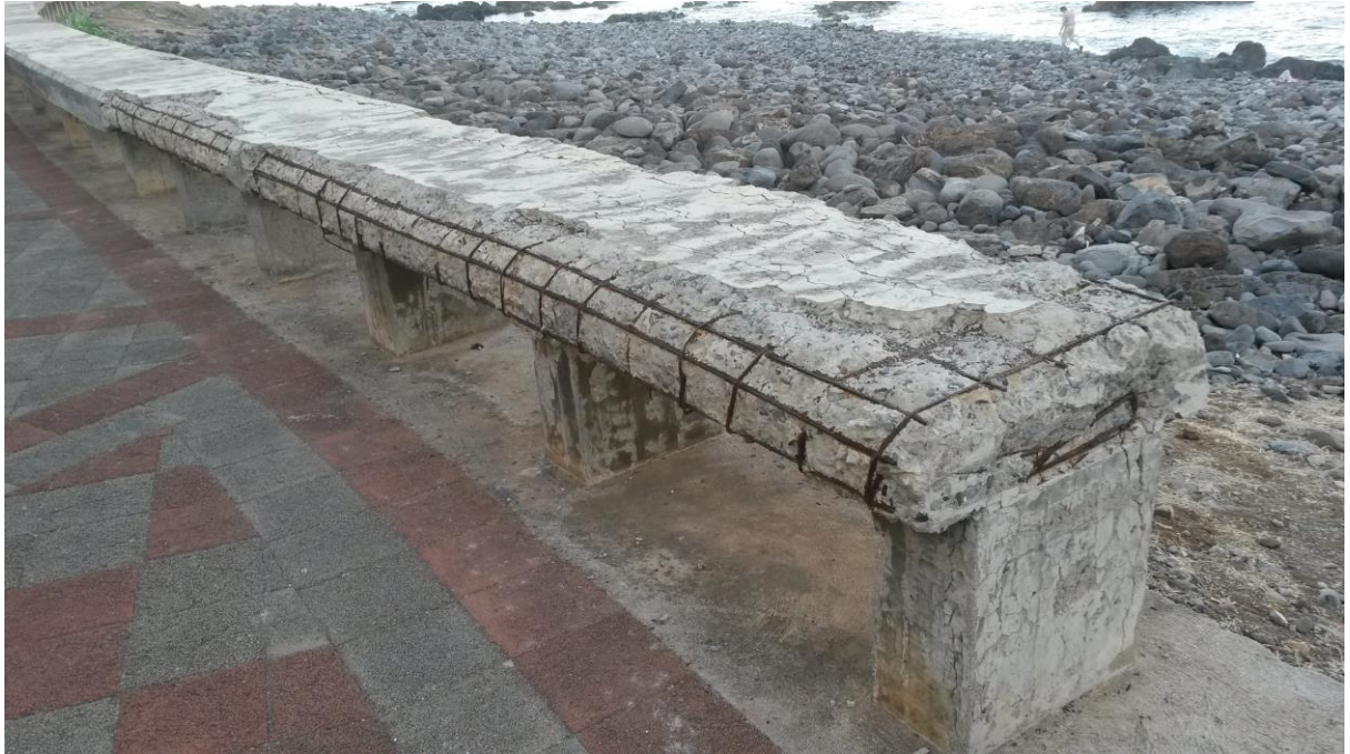
Figura 4.35 – Estado avançado de degradação do elemento de betão armado
