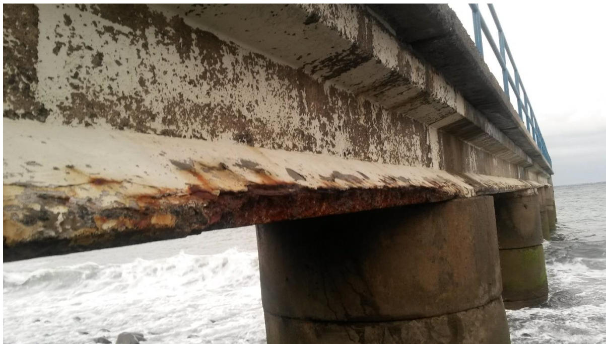
Figura 4.43 – Corrosão das armaduras numa zona tracionada de um tabuleiro numa ponte
