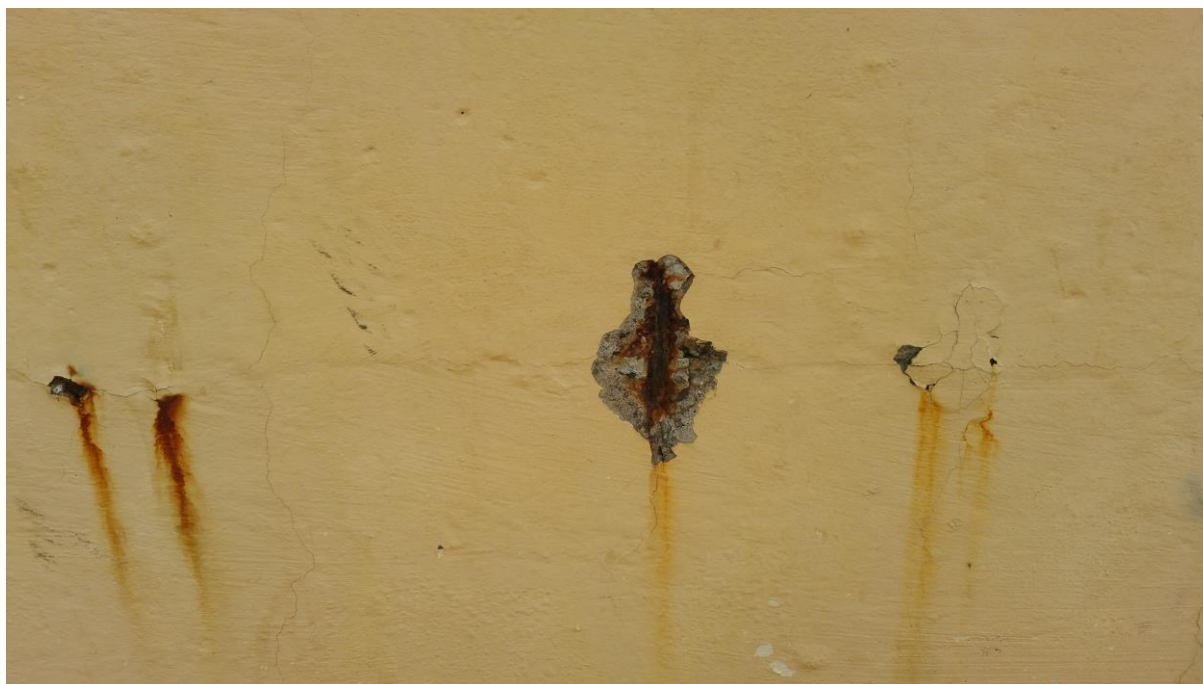
Figura 4.4 – Mau posicionamento das armaduras
