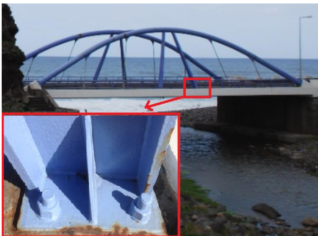
Figura 83 - Apresentação de corrosão na estrutura
