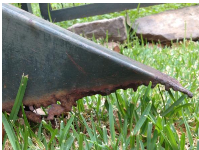
Figura 45 - Aço galvanizado enterrado em zona industrial
