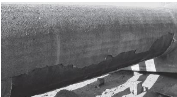
Figura 61 - Fragmentação de Argamassa hidráulica [14]
