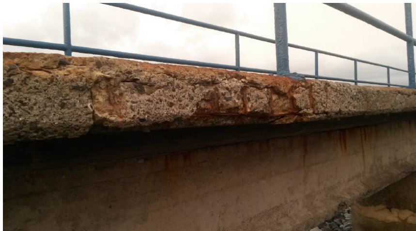
Figura 2.10 – Corrosão das armaduras de um tabuleiro numa ponte (Alves, 2016)
