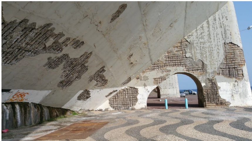
Figura 2.9 – Degradação dos pilares e da laje de suporte do aterro (Alves, 2016)
