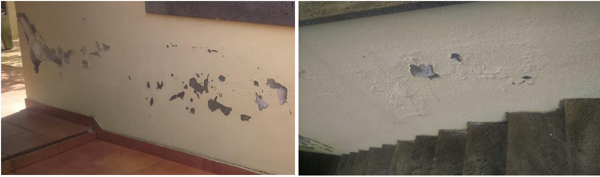
Figura 7 - Anomalias observadas nas paredes exteriores e muros
