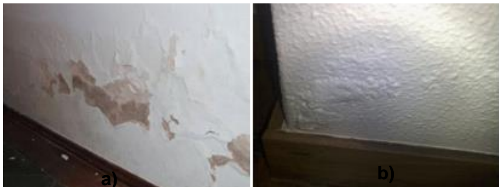
Figura 15 - Anomalias em acabamentos por pintura: a) destacamento (Marques, 2013); b) empolamento (Marques, 2013)
