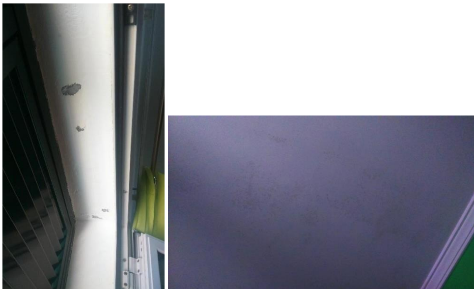
Figura 11 - Anomalias observadas no quarto 1
