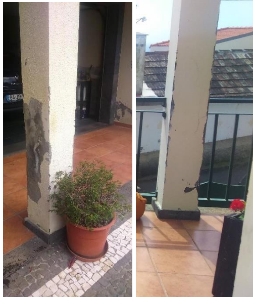
Figura 9 - Anomalias observadas nos pilares
