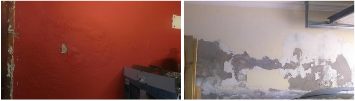
Figura 12 - Anomalias observadas nas paredes do rés-do-chão
