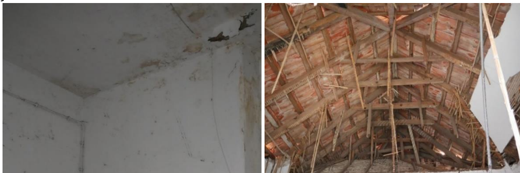
Figura 9 - Anomalias nas paredes interiores e tetos
