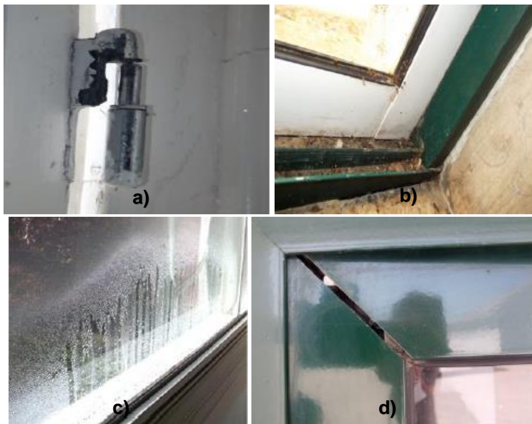
Figura 13 - Anomalias em caixilharias: a) Parafuso de fixação danificado (Vicente, 2012); b) acumulação de detritos (Vicente, 2012); c) condensação no interior do vidro (Santos A. J., 2012); d) juntas abertas/frestas (Vicente, 2012)
