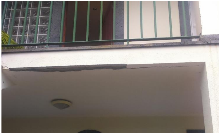
Figura 8 - Anomalias observadas na varanda
