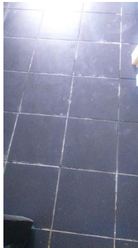
Figura 13 - Anomalias observadas no pavimento
