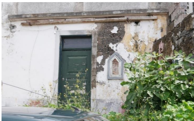
Figura 8 - Anomalias nos paramentos exteriores
