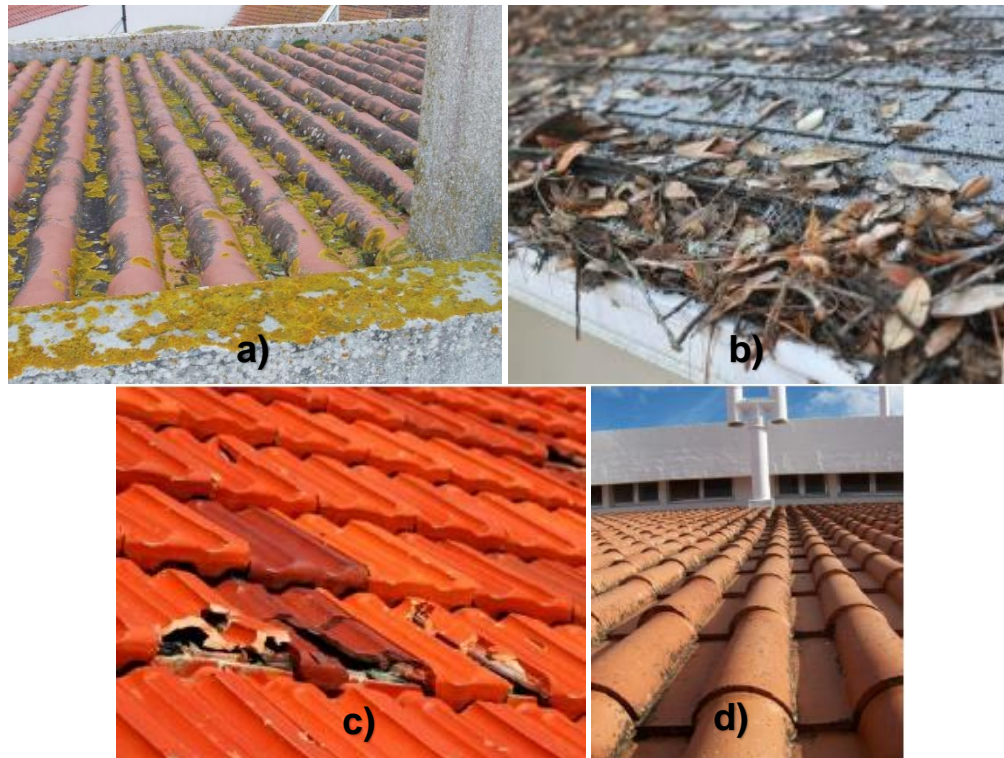
Figura 11 - Anomalias no revestimento em coberturas inclinadas: a) desenvolvimento de colonização biológica (Principais patologias dos telhados, 2018); b) acumulação de detritos (McLean Roofing and Siding, 2018); c) fraturação de telhas (MaiFix, 2018); d) telhas desalinhadas (Garcez, 2009)
