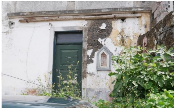
Figura 41 - Anomalias nos paramentos exteriores
