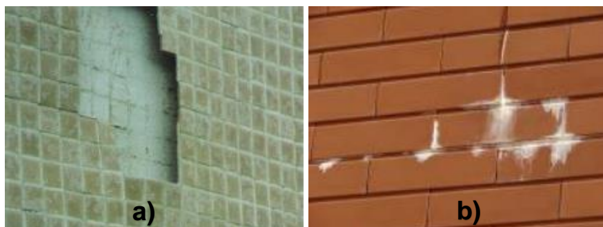
Figura 16 - Anomalias em acabamentos cerâmicos: a) deslocamento (Bento, 2010); b) eflorescências (Morais, 2007)
