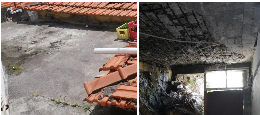
Figura 40 - Anomalias na cobertura em terraço
