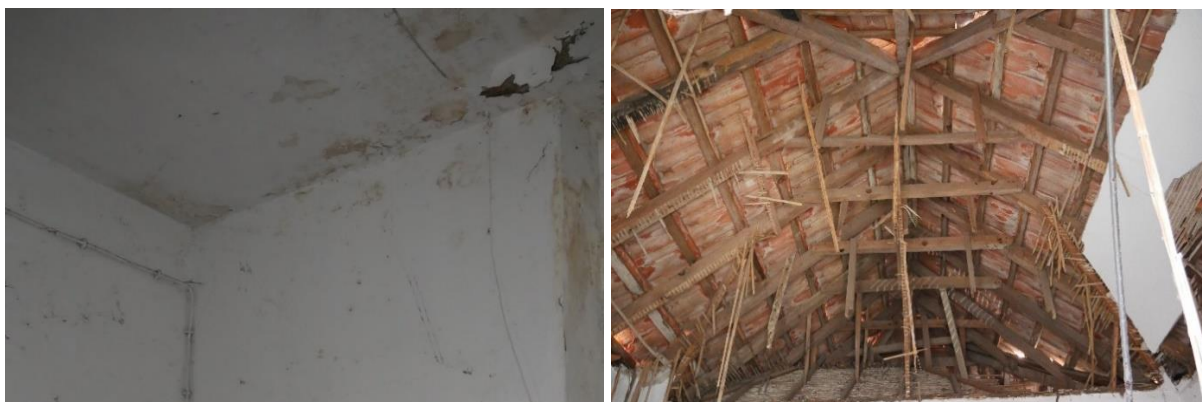
Figura 42 - Anomalias nas paredes interiores e tetos
