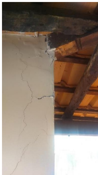
Figura 10 - Anomalias causadas devido à construção da cobertura da churrasqueira
