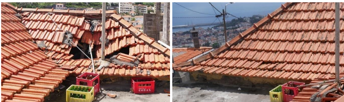
Figura 6 - Anomalias na cobertura inclinada
