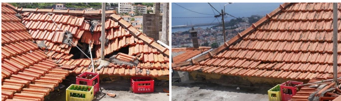
Figura 39 - Anomalias na cobertura inclinada
