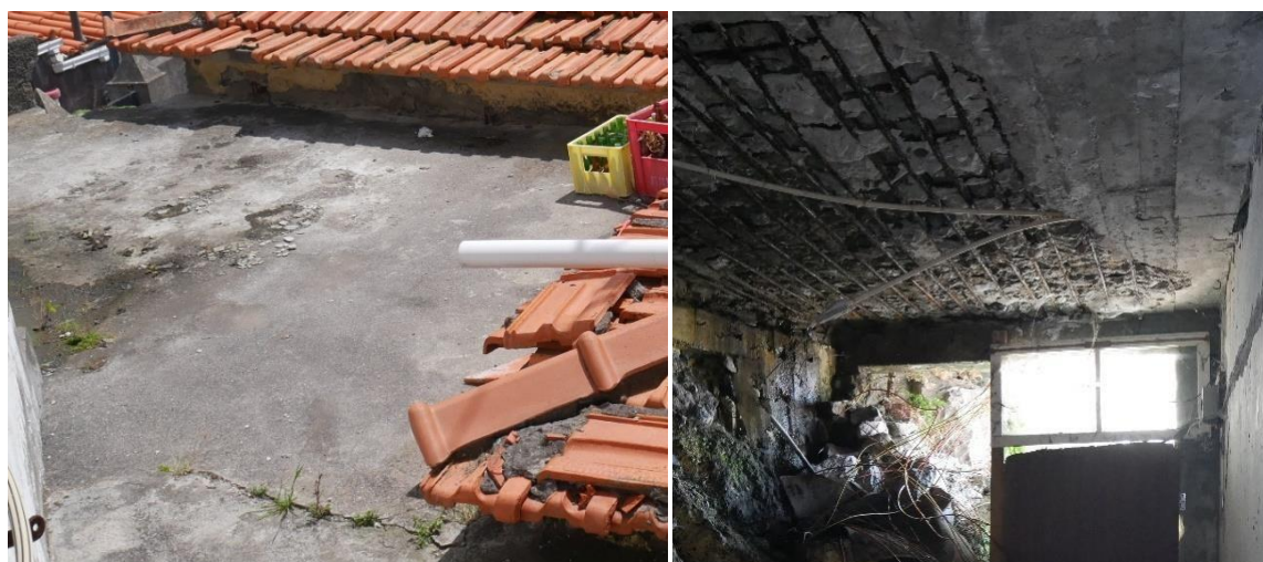
Figura 7 - Anomalias na cobertura em terraço
