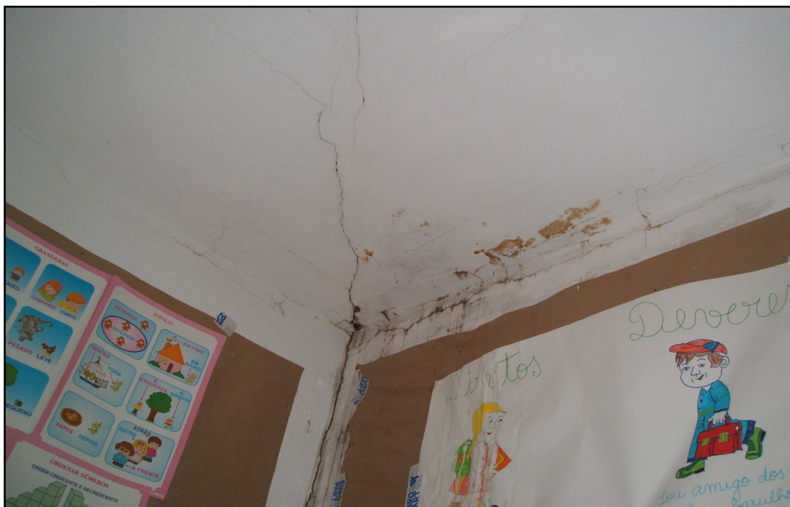
Fotografia n.º 4 – Panorama da degradação da sala 3
