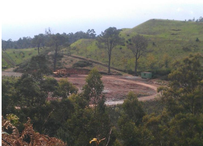
Figura 2.8 – Aterro legal, situado no Caminho das Carreiras, empresa Quinta Terra Boa, Lda.
