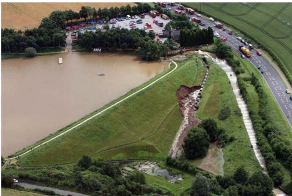
Figura 2 - Erosão numa barragem de terra causada pelo transbordamento do escoamento sobre as paredes de um descarregador (The Scottish Government, 2010).
