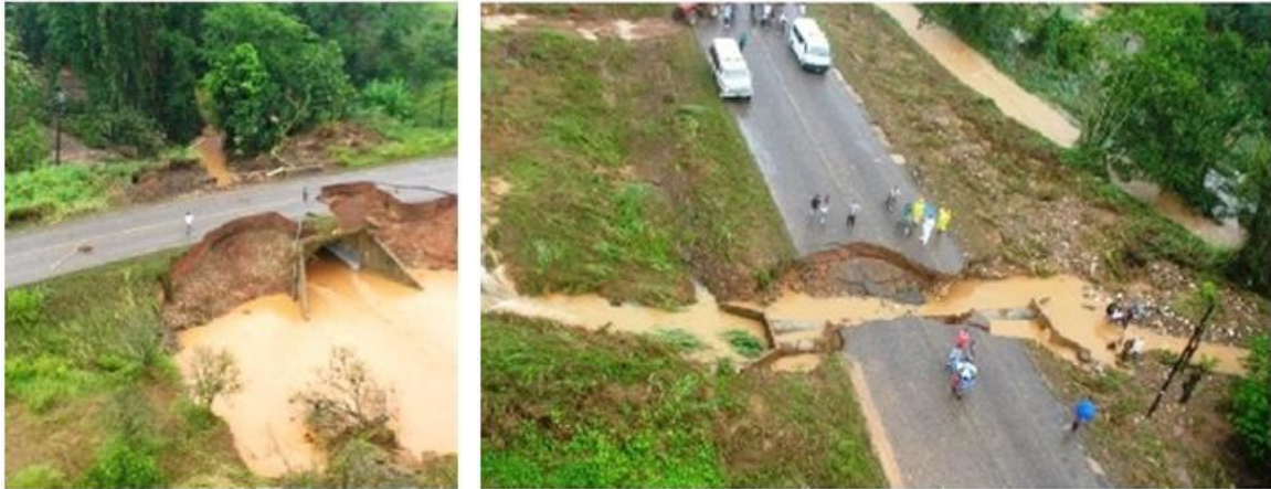
Figura 1 - Erosão a jusante de uma passagem hidráulica levando ao colapso da estrada e erosão da área adjacente (Government of Belize, s.d.).
