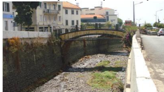
PSR20, topo das paredes laterais destruido, vista para jusante (cota - 20.0m).
