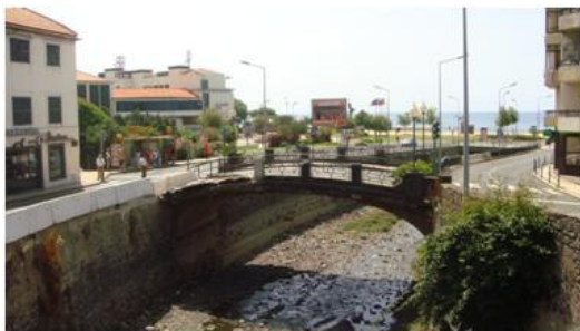
PSR21, ponte parcialmente destruida, vista para jusante (cota - 19.0m).
