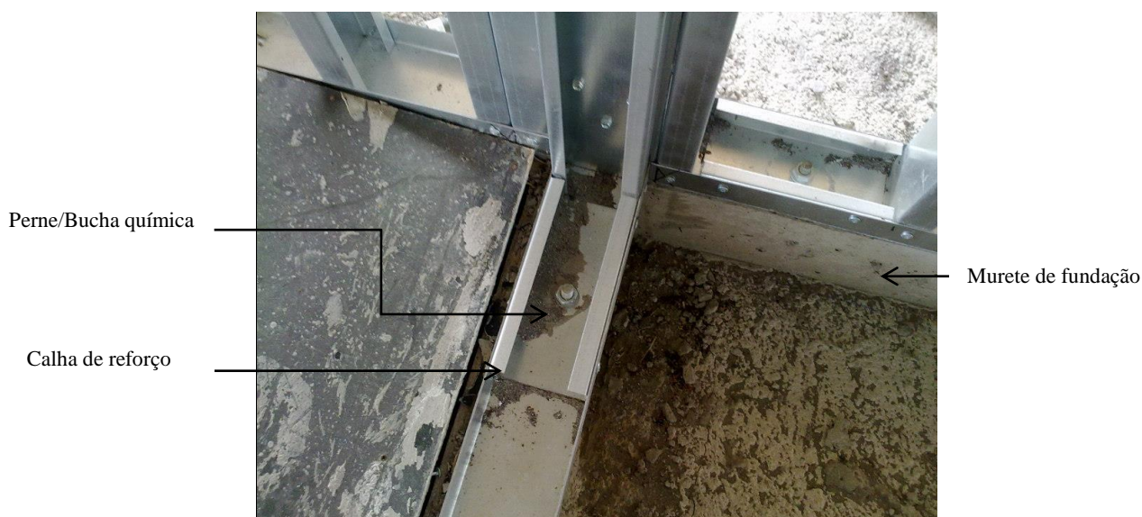
Figura 16- Exemplo de ancoragem entre estrutura metálica e fundação em betão armado (GoulartconstruçõesLda, 2013)
