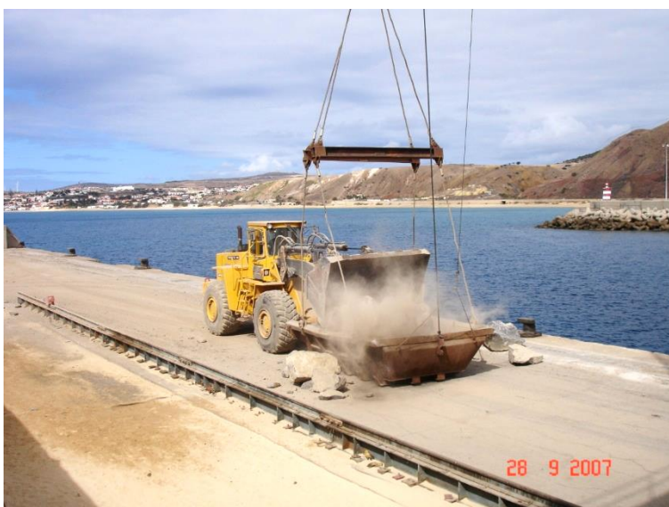
FIGURA 14: Pá carregadora a depositar rochas na caixa metálica. FONTE: ETERMAR. Foto cedida pela Delegação do Funchal, 2011.
