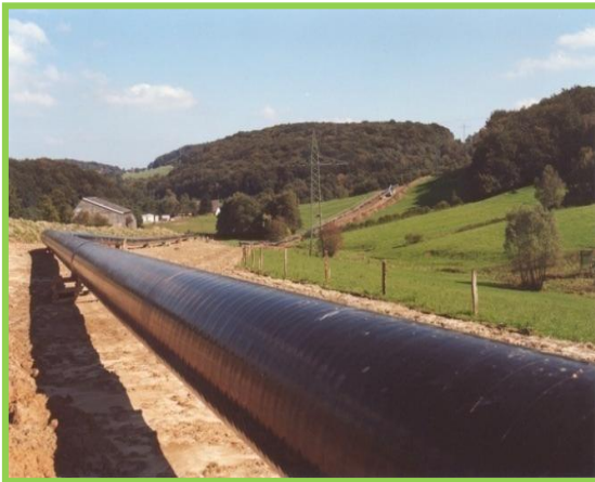
Figura 17: Monitorização de condutas de petróleo e gás [24]
