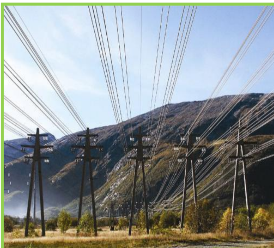
Figura 21: Monitorização de Linhas de Alta Tensão [24]
