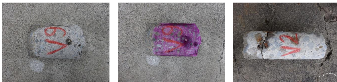
Figura 36: a) e b) Antes e depois do ensaio de carbonatação “in situ” (V9); c) Fracturação na altura de recobrimento (V2)
