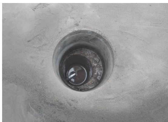
Figura 37: Furo na laje, separação entre camada de enchimento e da laje
