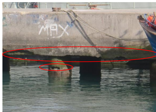
Figura 33: Perda de secção do banzo inferior e no pilar do Cais Sul
