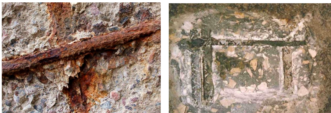
Figura 16: a) Efeitos da corrosão: b) Efeitos da corrosão negra
