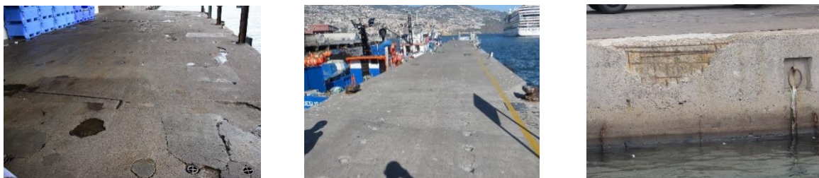
Figura 30: a) Pavimentos do Cais Norte; b) Pavimento do Cais Sul; c) Armaduras expostas
