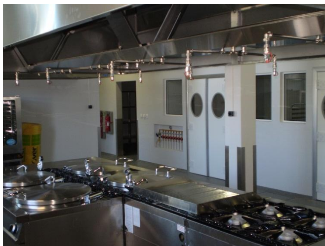
Fig. 15 - Sistema de detecção e extinção para cozinhas industriais.
