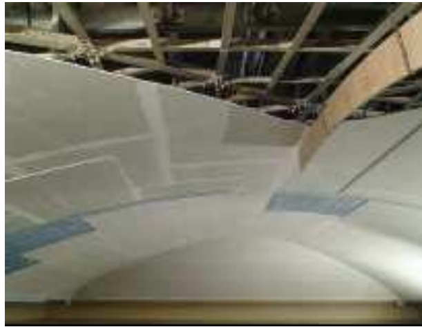
Fig. 63 - Execução de tecto falso com placas de silicato para garantir resistência ao fogo.
