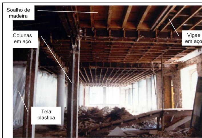
Figura 8 – Um andar do edifício Grandela que estava em obras de renovação (Fonte: Ventura, Neves e Valente, 2005).
