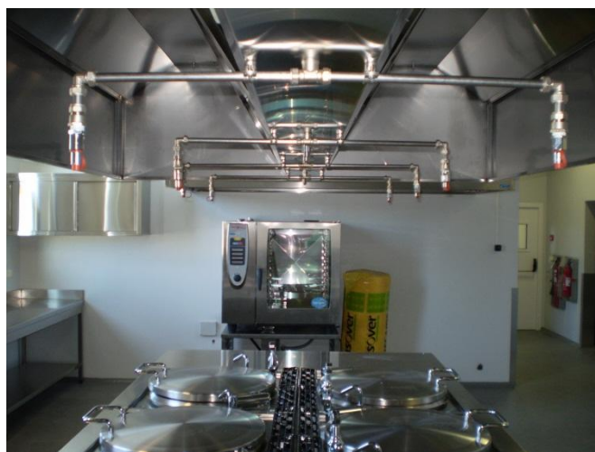
Fig. 16 - Sistema de detecção e extinção para cozinhas industriais.
