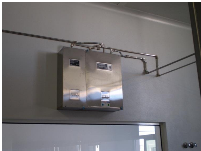
Fig. 14 - Sistema de detecção e extinção para cozinhas industriais.
