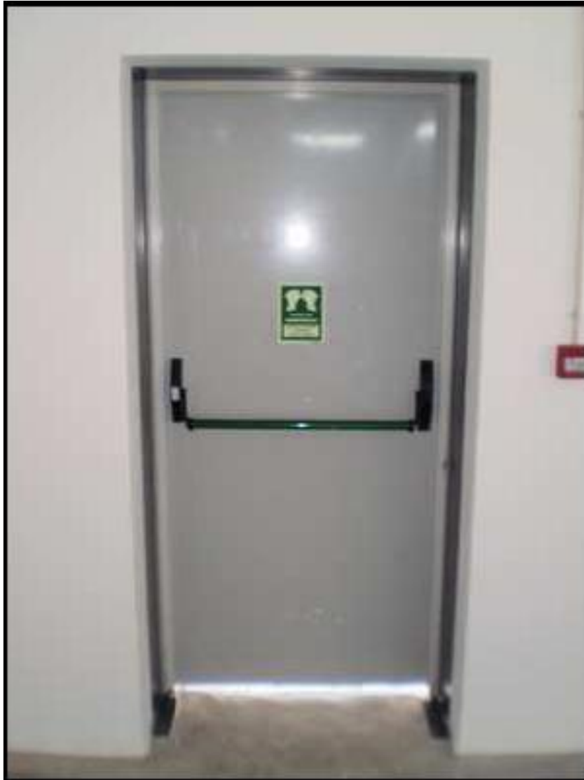
Fig. 24 - Instalação de porta corta-fogo com barra anti-pânico.
