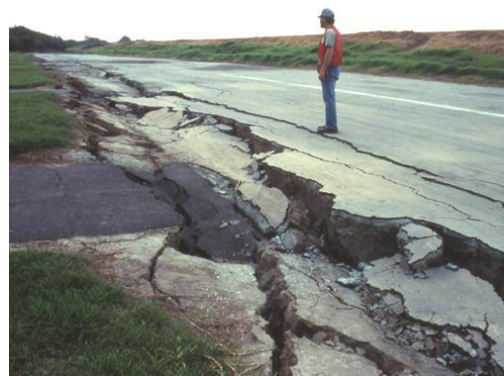
Figura 37 – Espalhamento Lateral, Loma Prieta, Califórnia - EUA.
