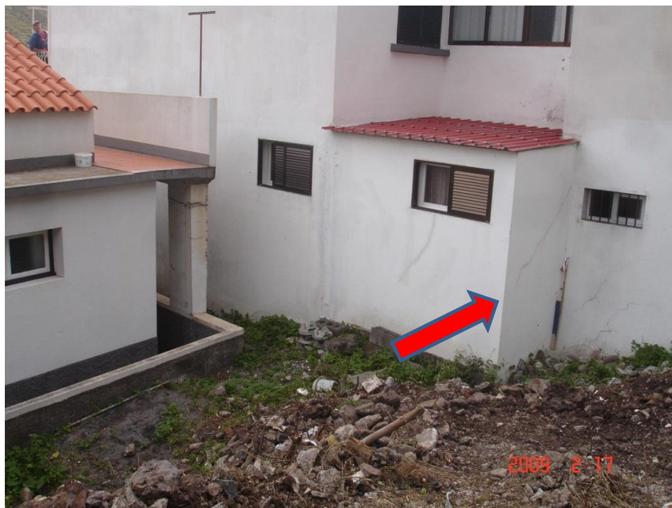
Figura 40- Fissuras diagonais de grande expressão - Moradia Nº2.
