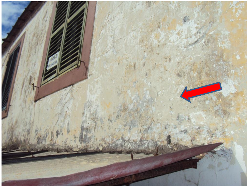
Figura 45 - Fissuras diagonais com grande expressão- Moradia Nª4.
