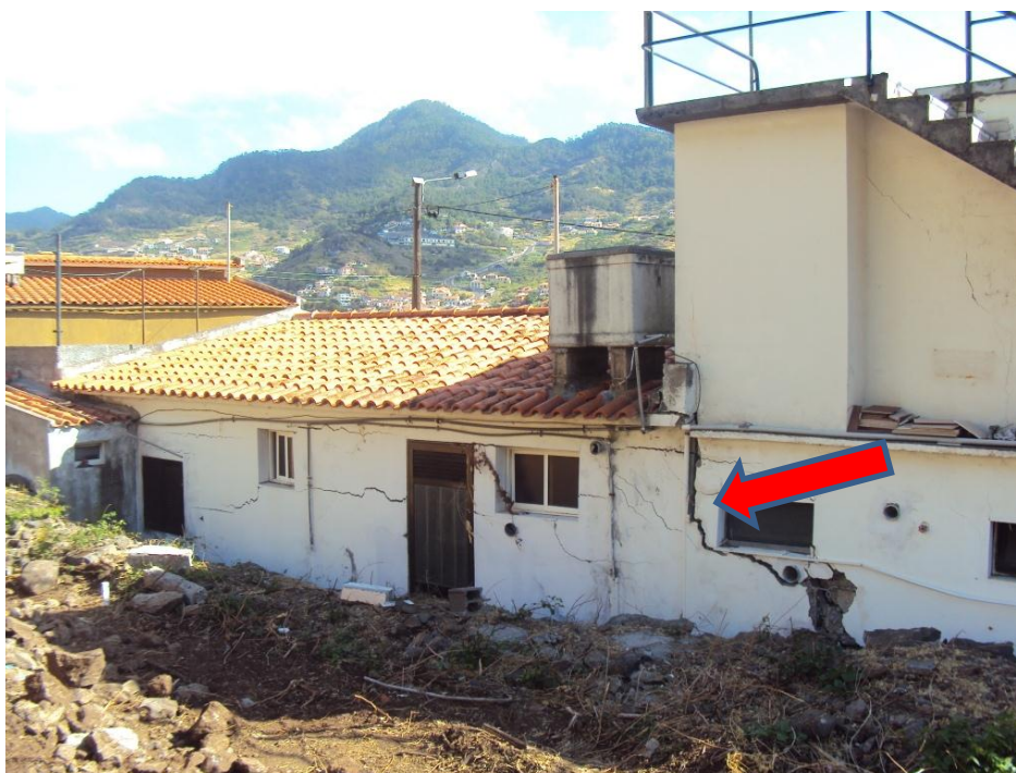
Figura 51 - Inúmeras fissuras presentes na moradia resultantes pelo movimento do solo-Moradia Nº7.
