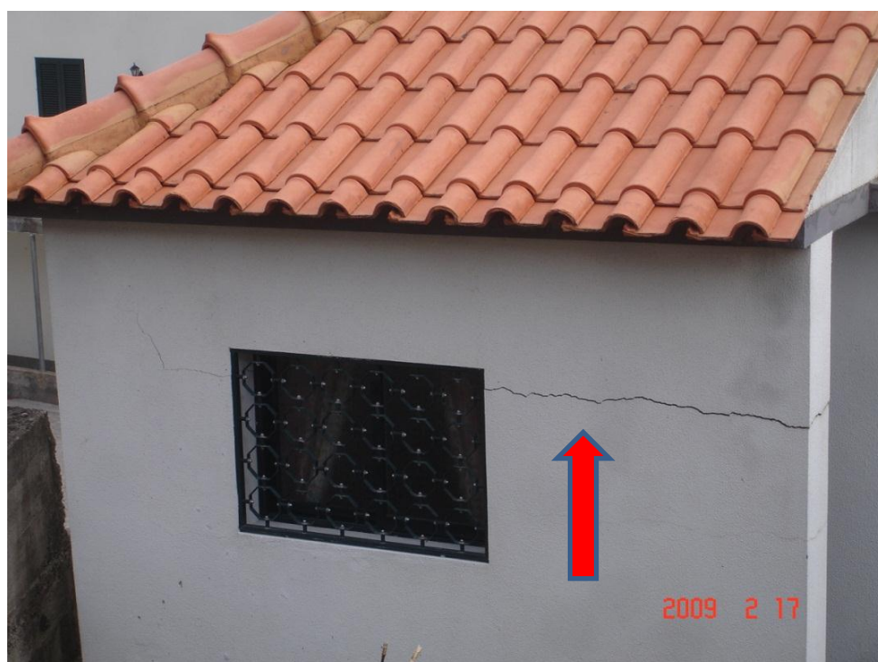
Figura 41-Fissuras horizontais com grande desenvolvimento- Moradia Nº2.
