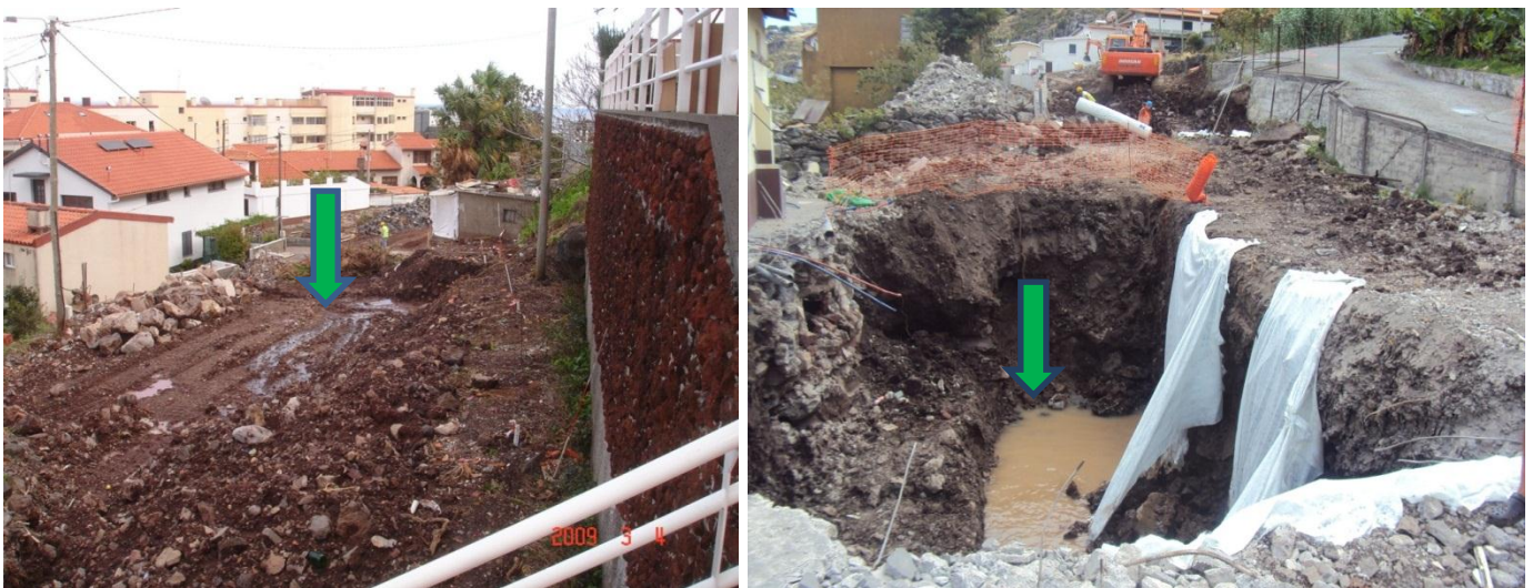
Figura 65 - Presença de água no solo de fundação, Ramal 6.1.
