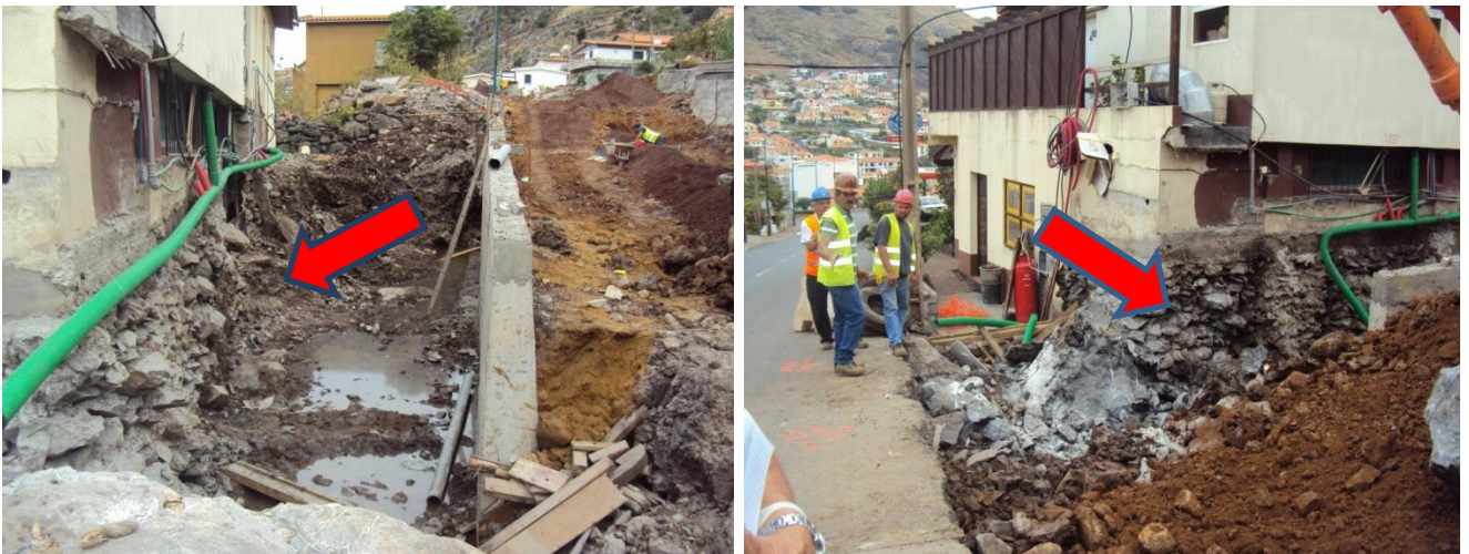
Figura 28- Moradias vizinhas á obra com fraca qualidade construtiva.
