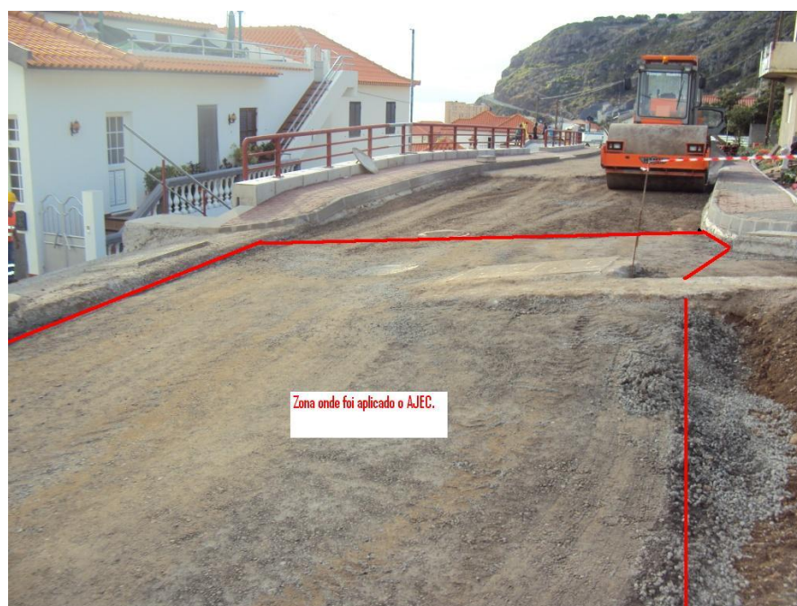
Figura 18- Foto da zona onde foi aplicado o reforço da estrutura de pavimento do Ramal 6.2 (AJEC).
