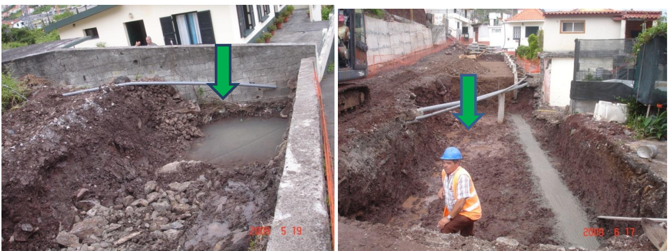
Figura 66 - Presença de bolsas de água no solo de fundação, Ramal 9.
