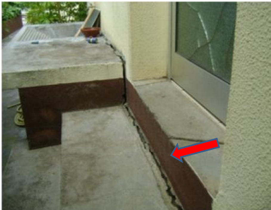
Figura 53 - Fissuras e assentamentos - Moradia N o 8.
