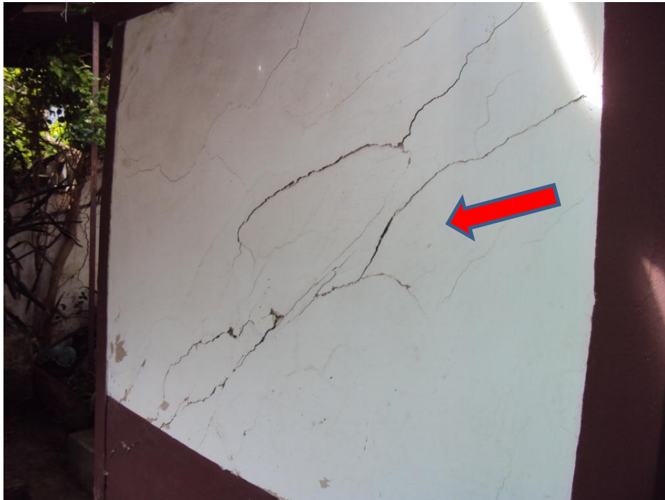
Figura 44 - Fissuras diagonais com grande expressão- Moradia Nª4.
