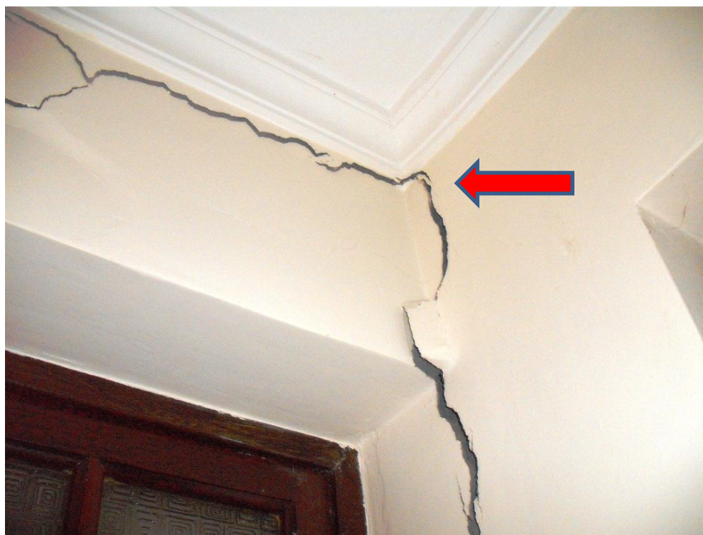
Figura 37- Foto de pormenor de fendas de grande expressão - Moradia Nº1.
