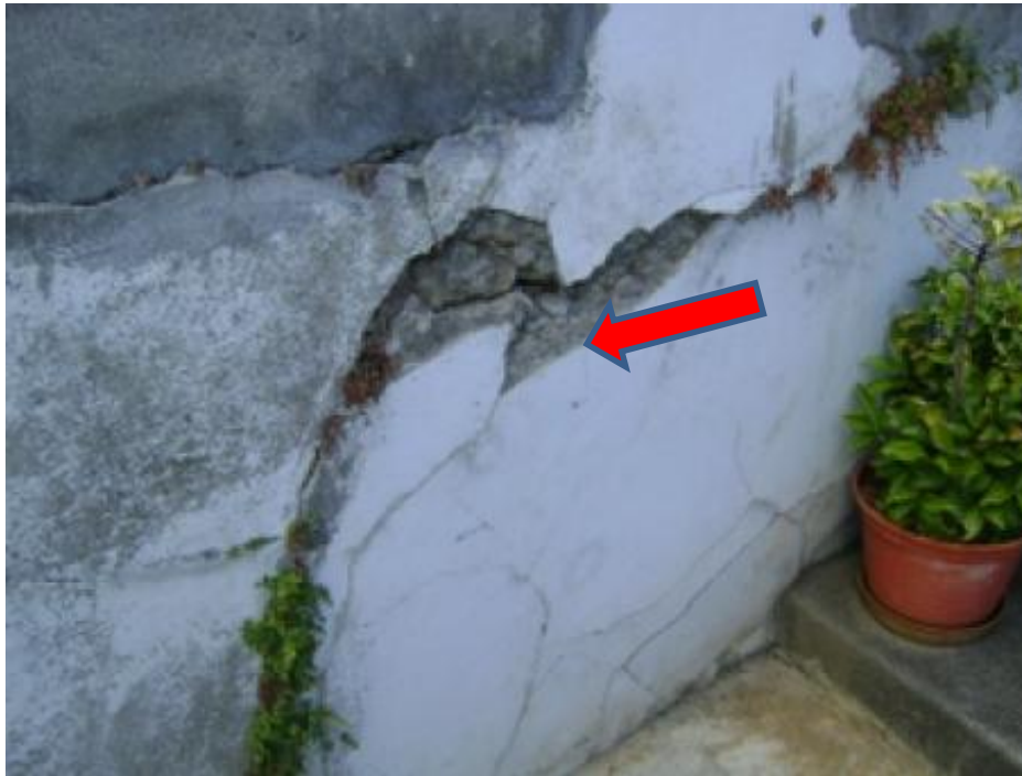
Figura 48 - Fissuras nos Muros de suporte provocadas pelo movimento de vertente- Moradia N°6.
