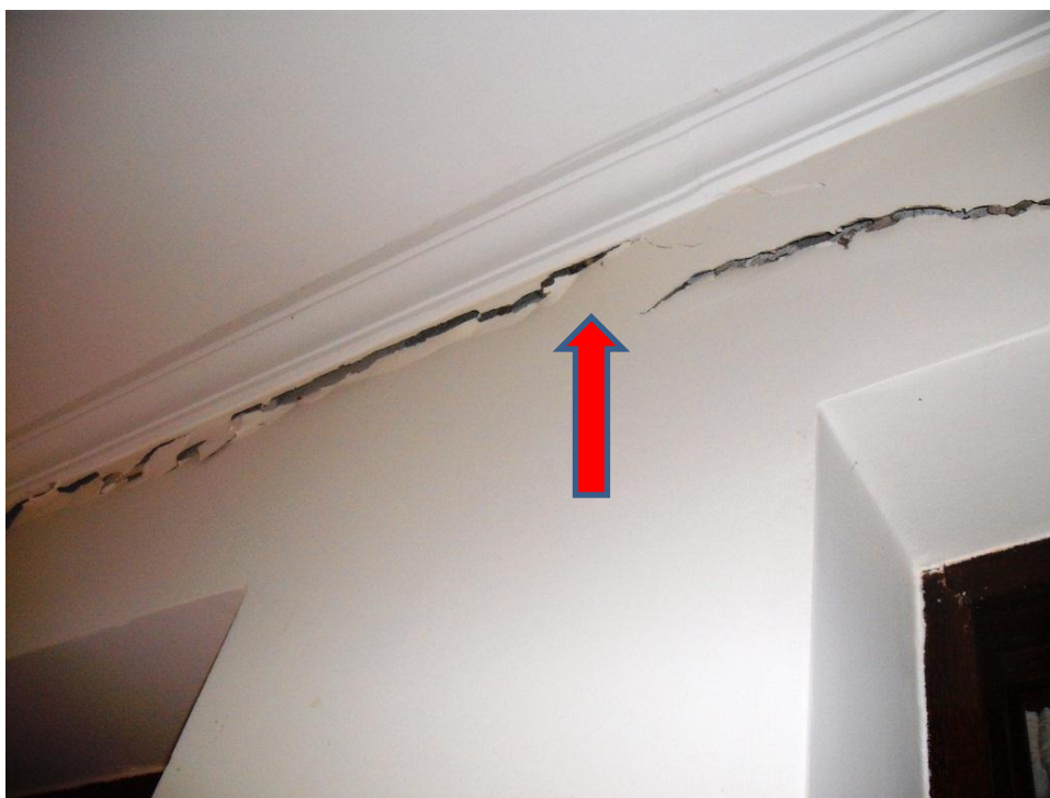
Figura 39 - Fendas de grande expressão - Moradia Nº1
