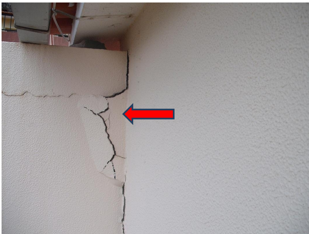
Figura 36- Fissuras horizontais e verticais de grande expressão - Moradia Nº1.
