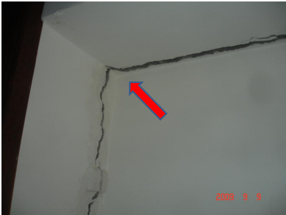
Figura 38- Foto de pormenor de fendas de grande expressão - Moradia Nº1
