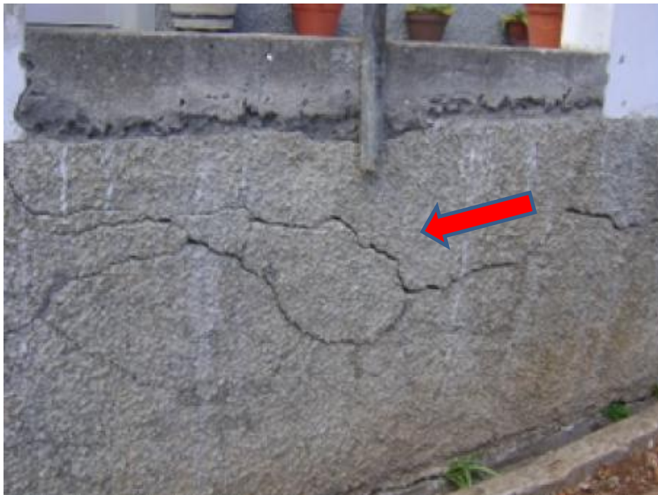
Figura 49 - Fissuras nos Muros de suporte provocadas pelo movimento de vertente- Moradia N°6.
