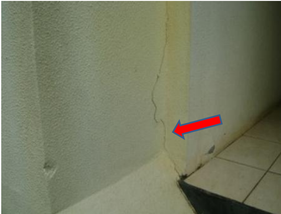
Figura 52 - Inúmeras fissuras presentes na moradia resultantes pelo movimento do solo - Moradia N o 8.
