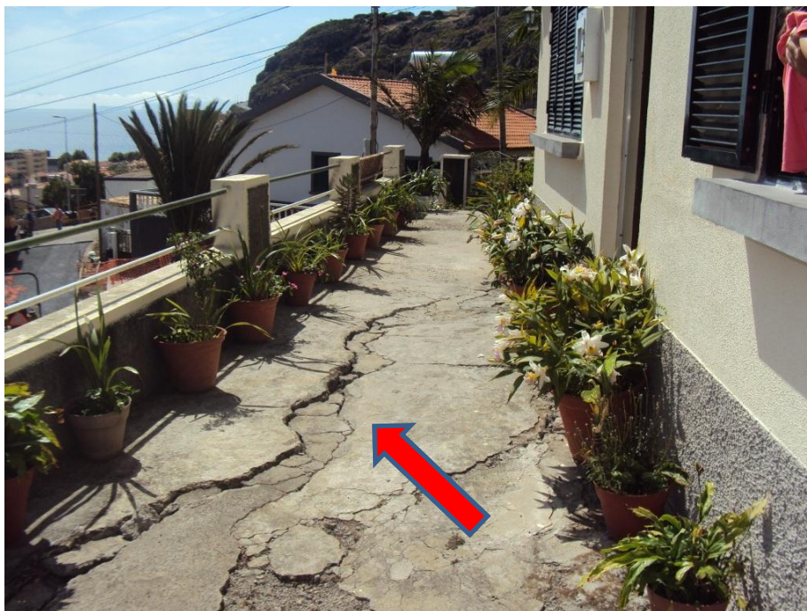
Figura 46 - Panorâmica das fissuras no pavimento provocadas pelo movimento de vertente-Moradia Nº5.
