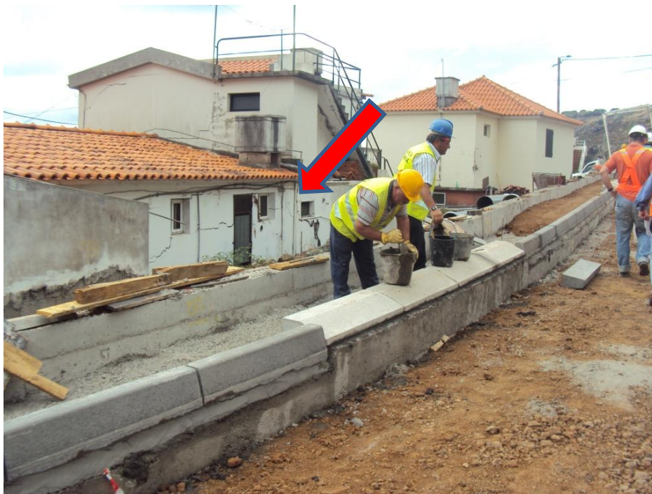
Figura 50 - Panorâmica das fissuras provocadas pelo movimento de vertente-Moradia Nº7.
