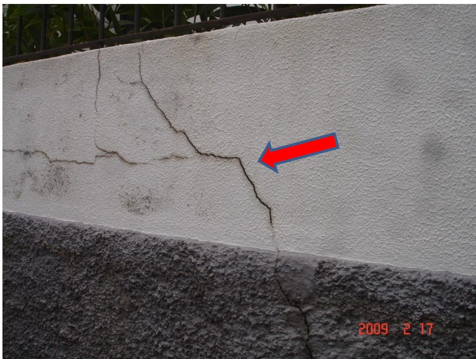
Figura 43 - Fissuras diagonais nos Muros de suporte da moradia com grande desenvolvimento- Moradia N°3.
