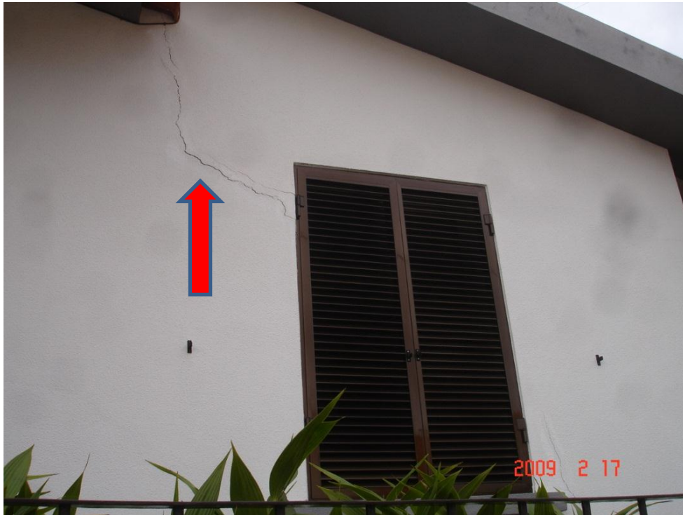
Figura 42-Fissuras diagonais com grande desenvolvimento- Moradia N°3.
