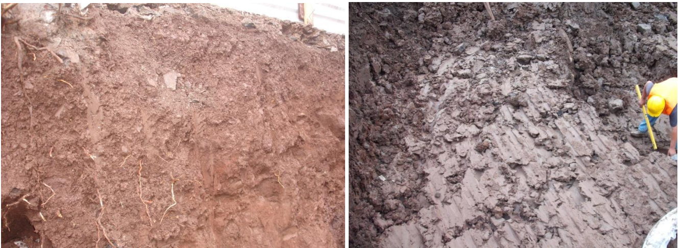
Figura 7 - Depósito de vertente na área da implantação dos muros de suporte.
