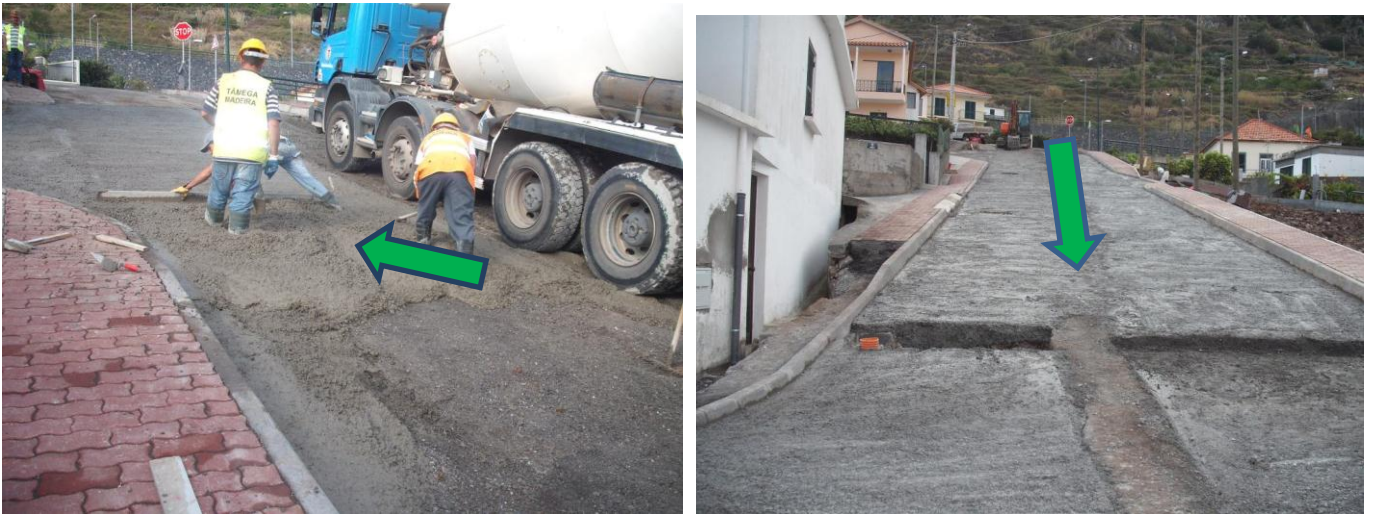
Figura 19- Fotos que demonstra a aplicação do betão com fibras (reforço do pavimento) na estrutura de pavimento do Ramal 6.2.
