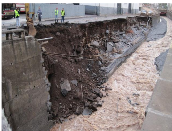
Figura 18 - Muro de suporte danificado (Fonte: SRES)
