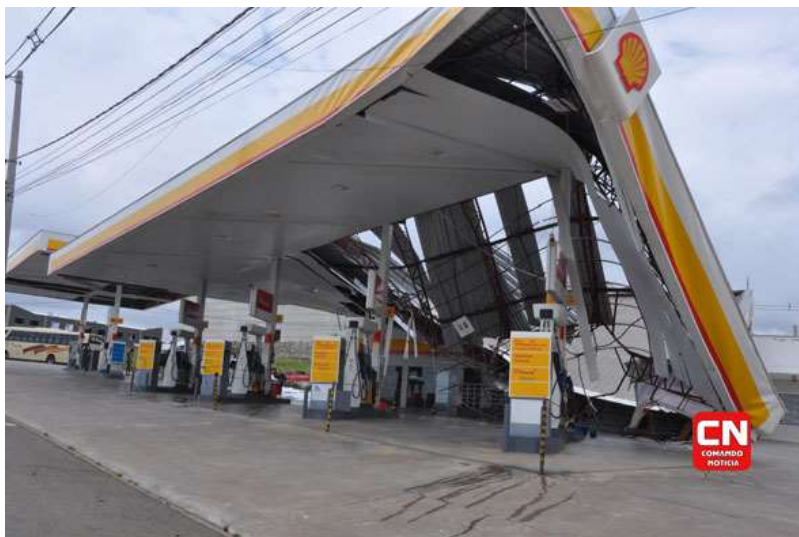
Figura 39 - Consequência de chuva e ventos fortes em posto de combustível, Indaiatuba [89].
