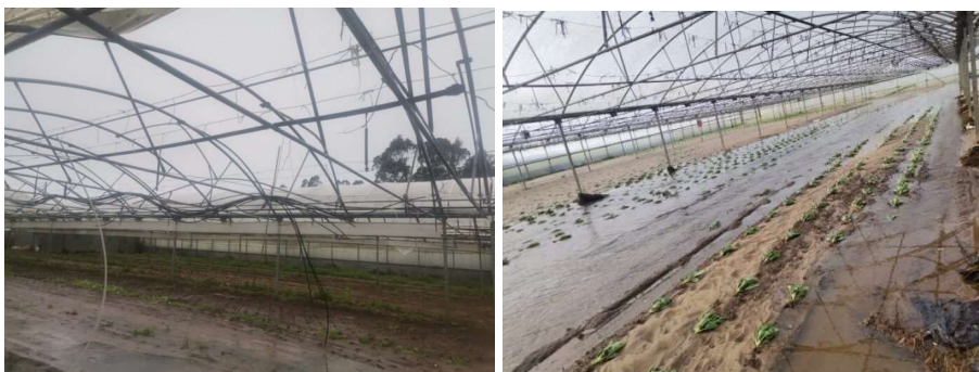
Figura 40 - Estufa agrícola destruída em Póvoa de Varzim [91].
