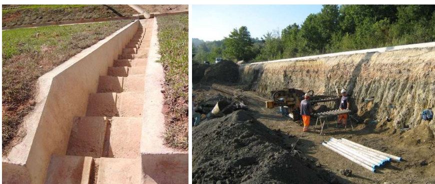
Figura 55 - Drenagem superficial do talude (esq) e Drenagem profunda do Talude (dir) [104].
