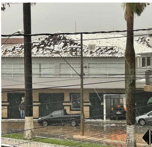
Figura 37 - Danos na cobertura devido a ação de granizo, Campos Gerais [84].
