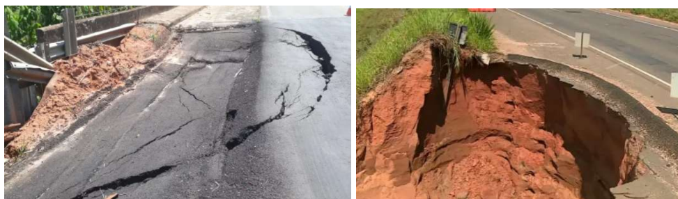
Figura 28 - Colapso do solo, São Paulo [65].
