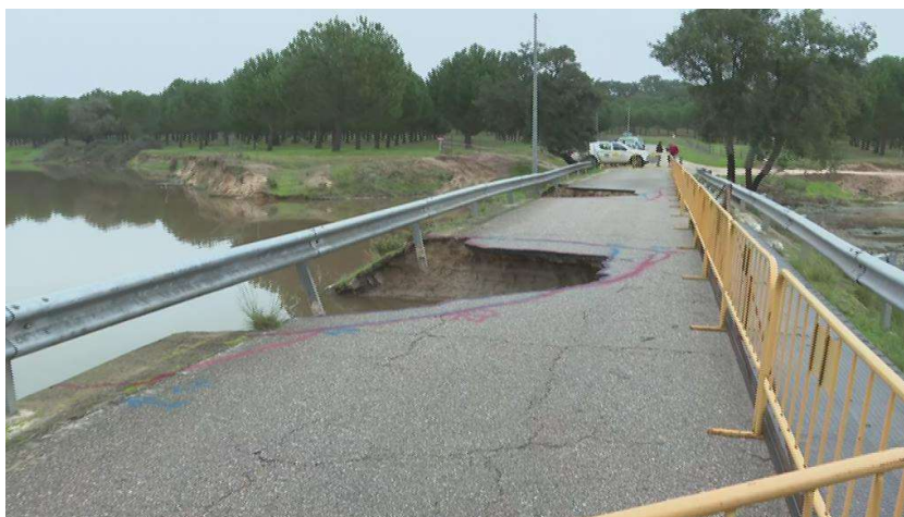
Figura 41 - Colapso da Ponte de Foros do Mocho, Portalegre [90].
