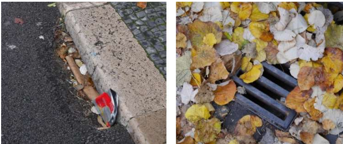
Figura 84 - Sargetas e sumidouros entupidos [108].
