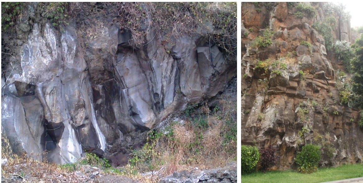
Figura 6.3: (A) maciço do talude da Peugeot e (B) maciço do talude da Achada
