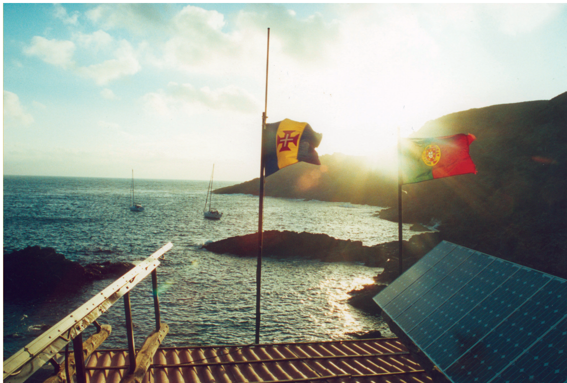
2. Foto - Sistemas Fotovoltaicos da Selvagem - 2008
